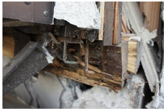
写真 28 写真 27 の柱脚接合部及び生物劣化
