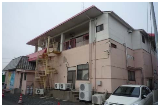
写真 1 筑西市女川で見られた S 造の被害
