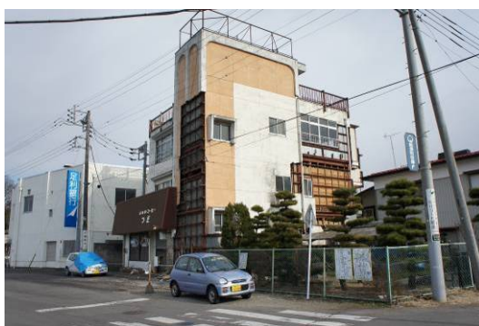
写真6 鉄骨造の被害
