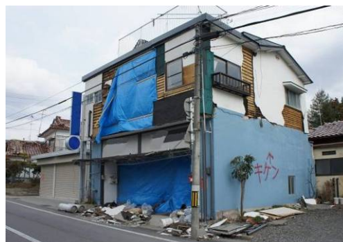
写真 44 店舗併用住宅の被害
