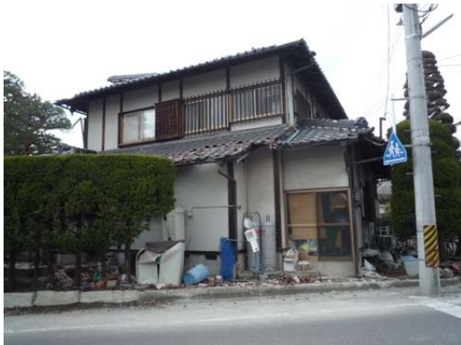
写真 57 屋根瓦の被害
