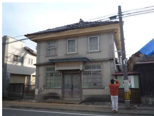
写真8 旧郵便局庁舎の被害
