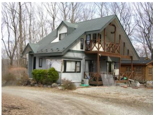
写真 17 窓ガラスの割れ（豊原乙地区）
