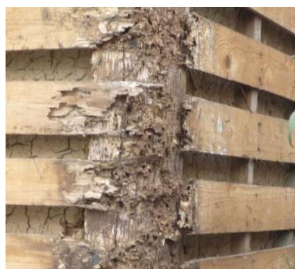
写真 48 写真 47 の柱・下地の生物劣化
