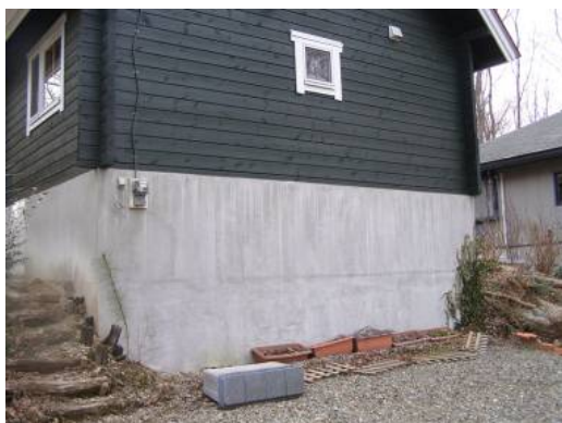
写真 15 高基礎部分のひび割れ(豊原乙地区)
