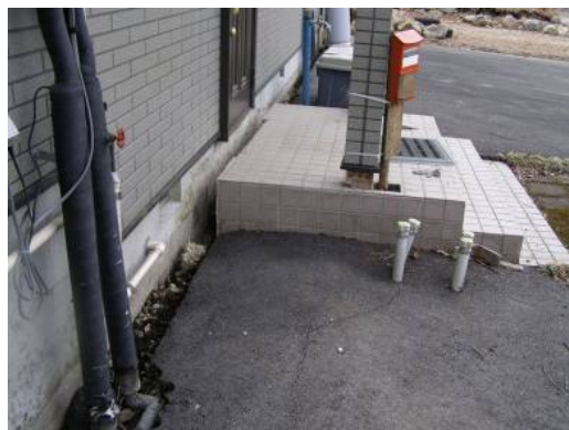
写真10 那須町豊原乙の別荘地の地盤変状
