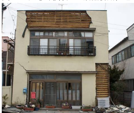
写真 47 外壁モルタルが剥落した住宅
