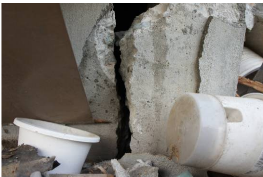
写真 29 写真 27 の基礎の被害
