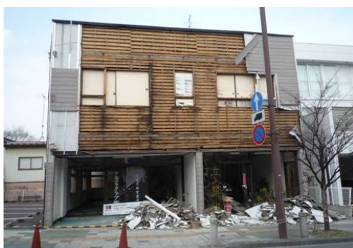
写真 43 ほぼ全面に渡り外壁モルタルが剥落した店舗併用住宅
