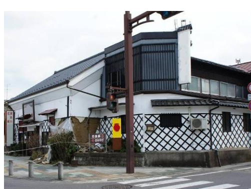
写真 42 土蔵を利用した店舗の被害
