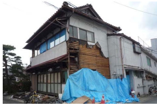
写真 52 階段室部分が崩壊した木造
