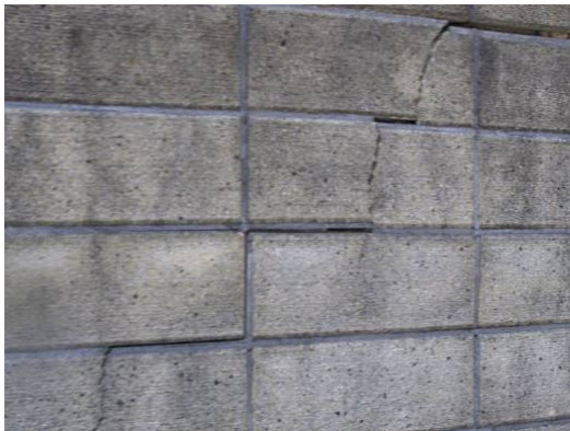
写真 35 塀のひび割れ
