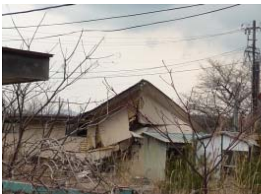
写真 72 倒壊した建築物
