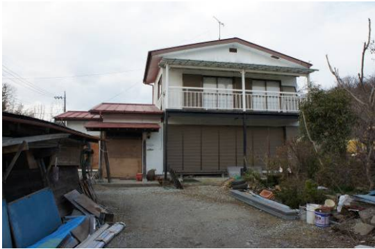
写真 27 大きく損壊した木造住宅(茶臼地区)
