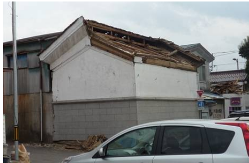
写真 54 屋根だけが崩壊した土蔵
