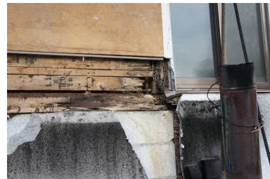
写真 30 写真 27 の浴室上部の生物劣化
