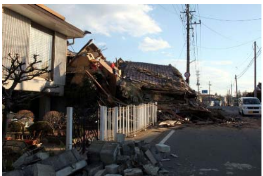
写真 65 南町の倒壊家屋（須賀川市役所ホームページより）
