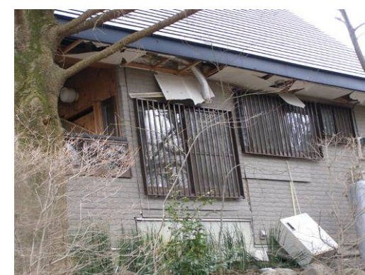
写真 18 軒裏天井の落下（豊原乙地区）
