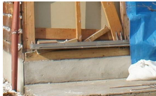
写真 22 写真 19 の柱脚、筋かい端部接合部
