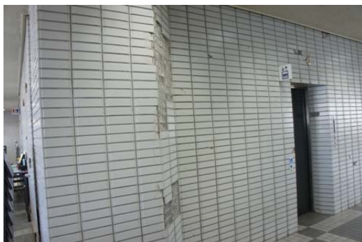
写真3 庁舎の内装タイルの剥落
