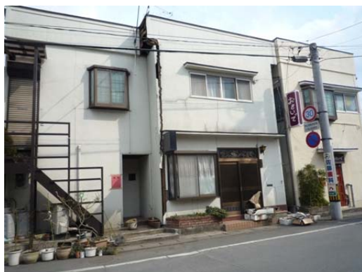
写真 49 外壁モルタルが剥落した住宅
