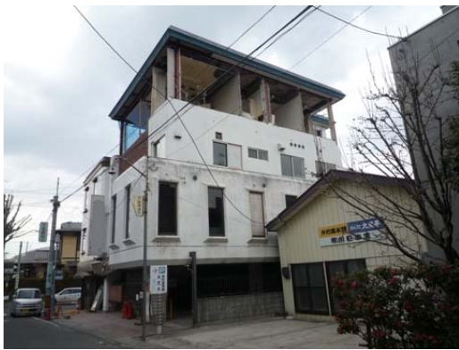
写真 63 4階の壁が崩落した鉄骨造
