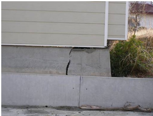
写真 39 住宅基礎の割れ
