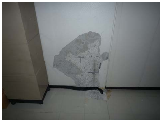
写真4 庁舎の構造躯体の損傷
