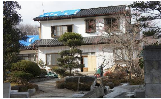
写真 20 住宅の外壁の剥落（西大久保地区）
