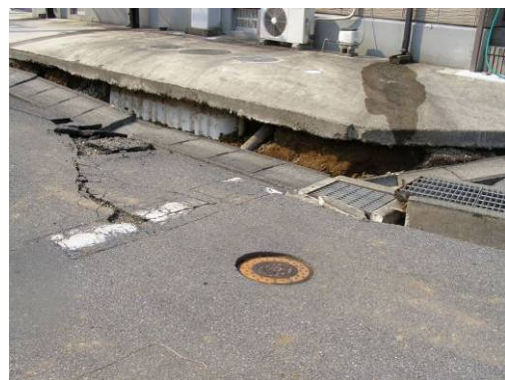
写真 38 宅地地盤の浮沈
