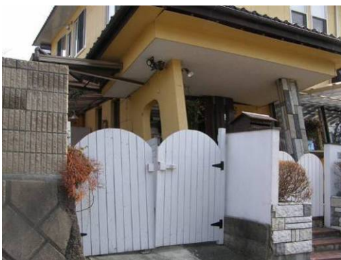
写真 41 地盤変状により大きく傾いた住宅
