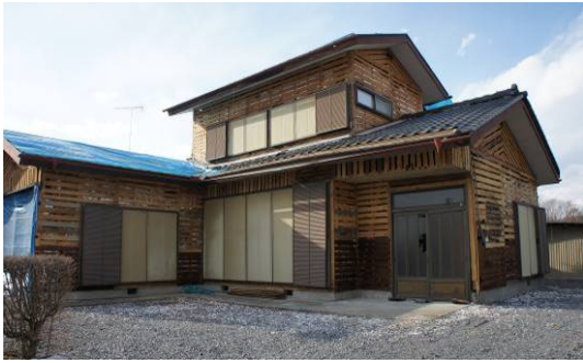
写真 19 住宅の外壁の剥落（西大久保地区）
