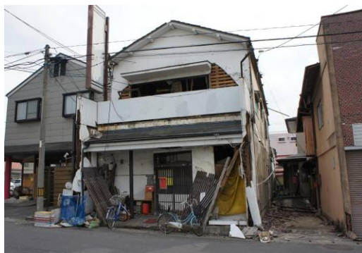
写真 45 大きく損壊した店舗併用住宅
