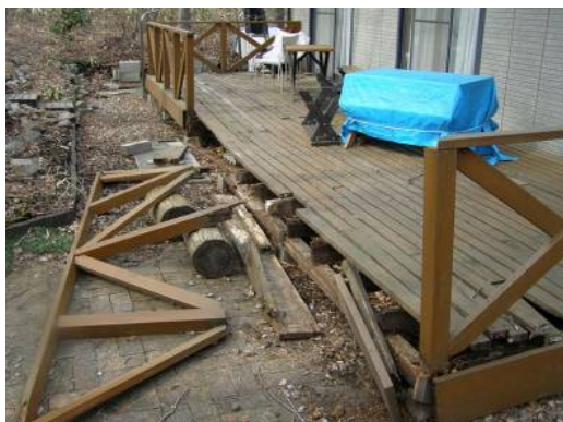
写真 11 ウッドデッキの損壊（豊原乙地区）
