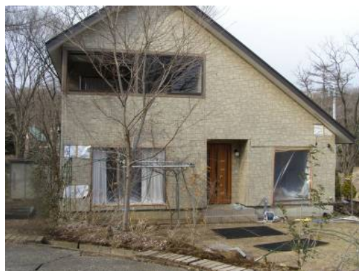
写真 16 サイディングの剥落（豊原乙地区）
