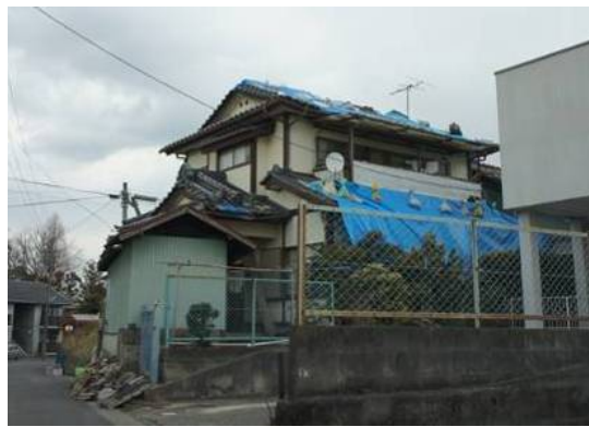
写真 64 屋根瓦の被害
