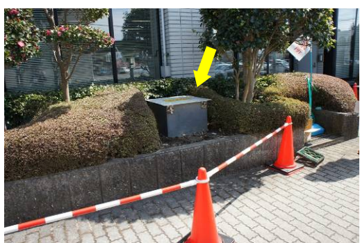
写真5 那須町震度計設置状況
