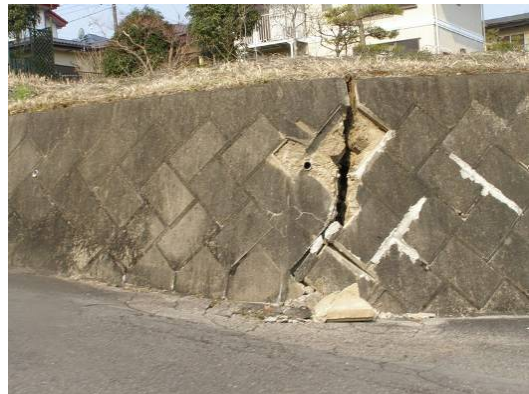
写真 36 擁壁のひび割れ
