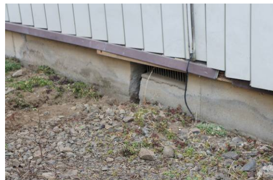
写真 26 写真 23 の無筋基礎のひび割れ
