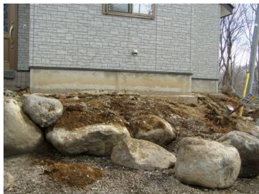
写真 12 外構の石の崩壊（豊原乙地区）
