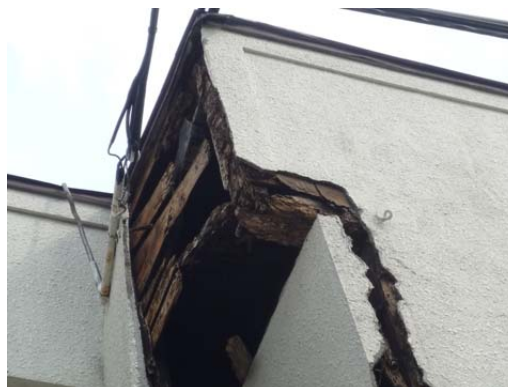
写真 50 写真 49 で外壁モルタルが落下する危険性のある状態
