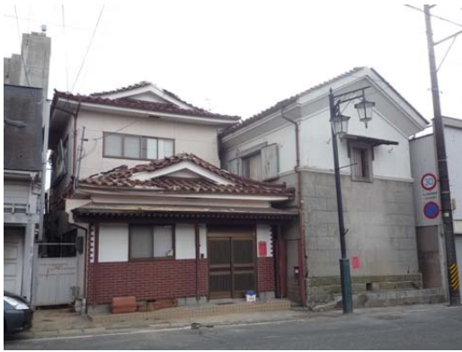
写真 59 残留変形が残る木造住宅
