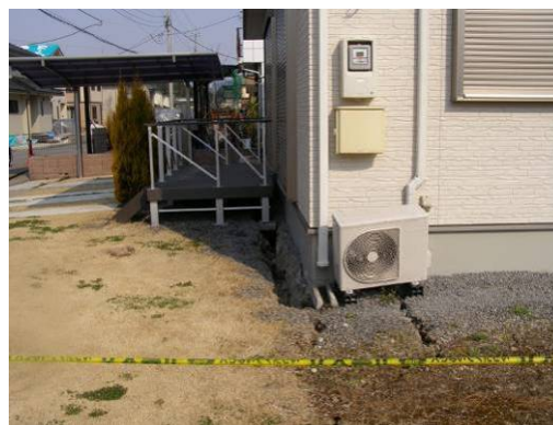
写真 34 地盤のひび割れとすべり
