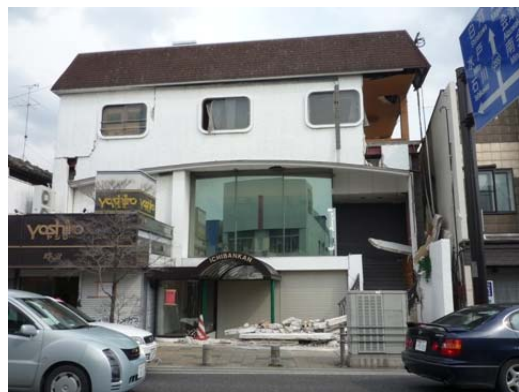
写真 62 3階の壁が崩落した鉄骨造
