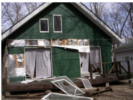
写真 13 大きく損壊した建物（豊原乙地区）
