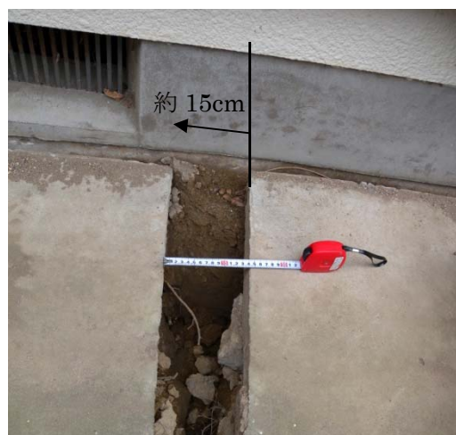
写真8 離間 (基礎は外観上ひび割れ等なし)
