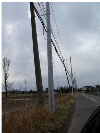
写真1 電柱の傾斜(復旧中)
