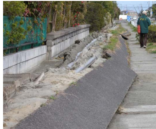
写真28 歩道脇の埋設配管の浮き上がり
