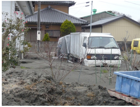
写真 1 9 タイヤの半分程度を埋める土砂
