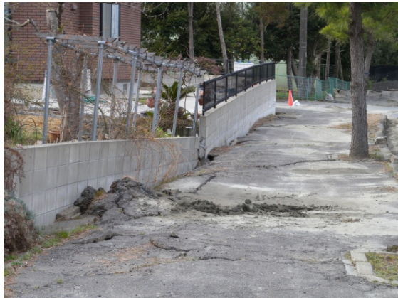
写真27 歩道部分の沈下に伴う塀の被害
