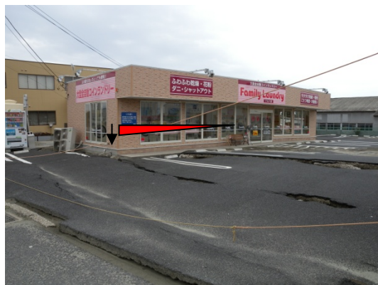
写真 1 4 片側が不同沈下した建築物 (同)
