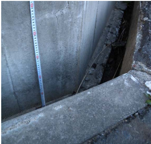
写真 3 9 外周部塀と前面道路との段差
