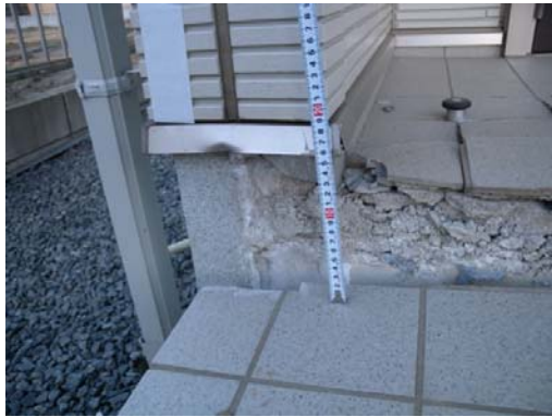
写真 4 1 建築物入口付近の段差
