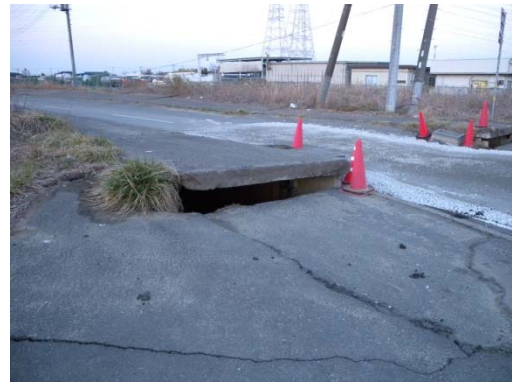
写真 4 2 周辺歩道部分の被害(段差約 40cm)
