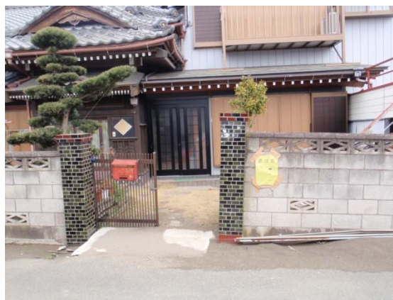
写真6 ブロック塀の段差
