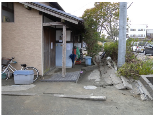
写真29 住宅玄関付近の沈下
