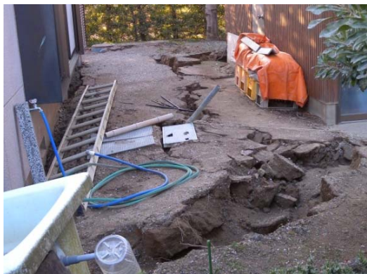
写真 3 7 敷地内の地割れ
