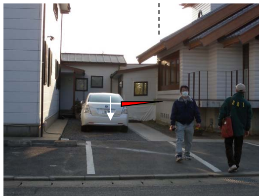
写真 3 6 接続部分の損傷及び駐車場
