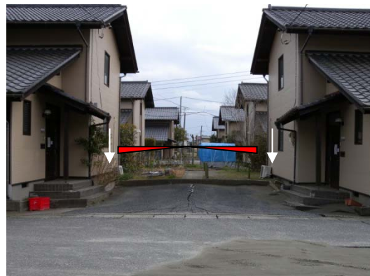
写真30 空地を挟んだ2棟の沈下
