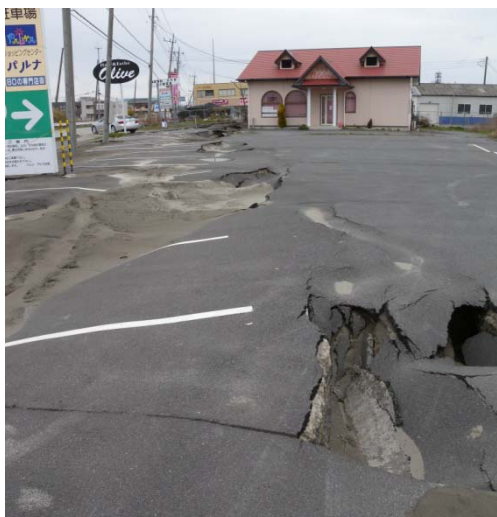
写真 1 3 駐車場路面の変状 (左側が県道 11 号)
