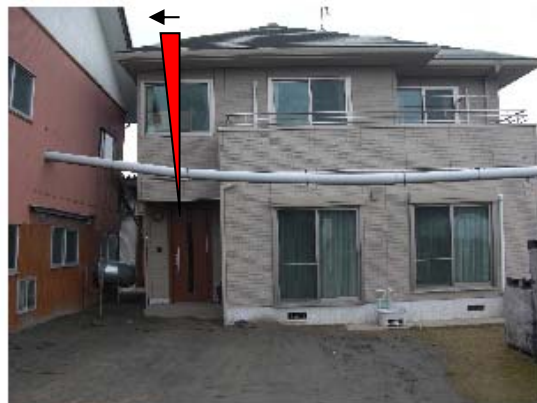
写真 2 5 † 傾斜した住宅
