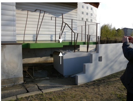
写真 3 5 スロープ部の段差
