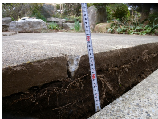
写真9 入口付近の沈下
