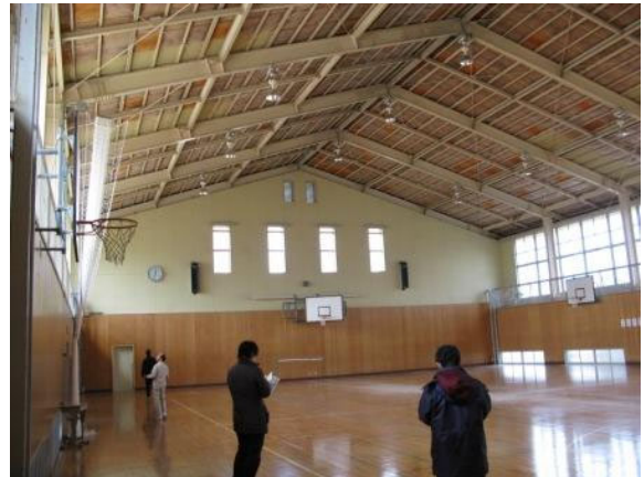
写真 16 体育館内部の状況
