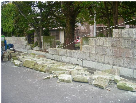
写真 71 知事公館の石塀の崩壊
