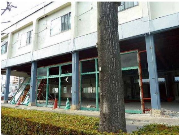
写真 39 ガラスの破損と支持枠の脱落
