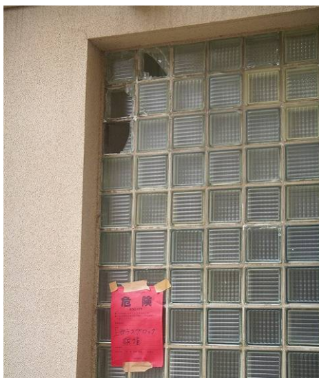
写真 69 ガラスブロックの破損
