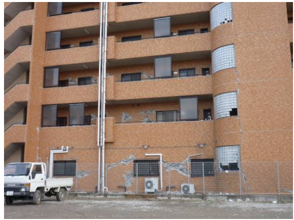
写真 33 非構造外壁の損傷
