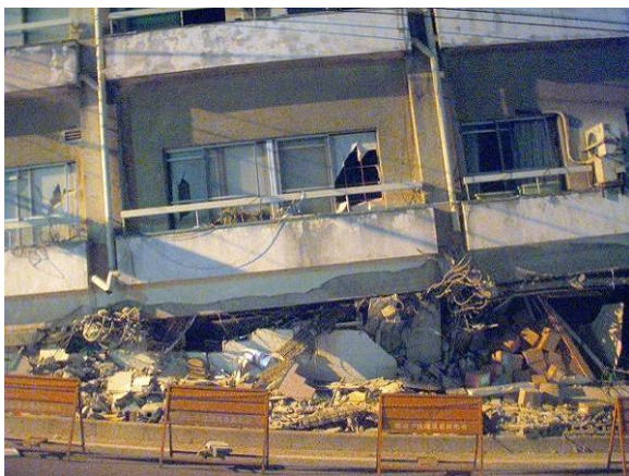
写真 54 ピロティー部の圧壊
