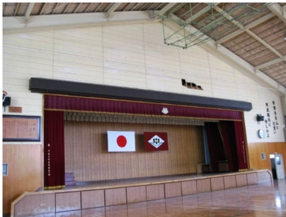
写真 9 ステージ上の内装仕上げ材の損傷
