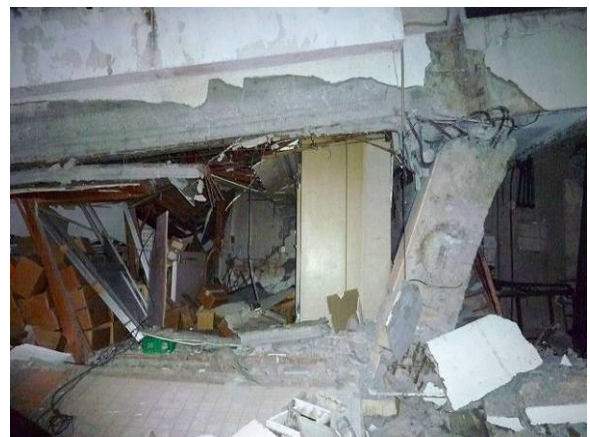
写真 55 1 階柱頭・柱脚の曲げ破壊
