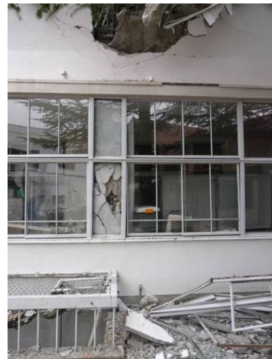
写真 77 1階柱のせん断破壊
