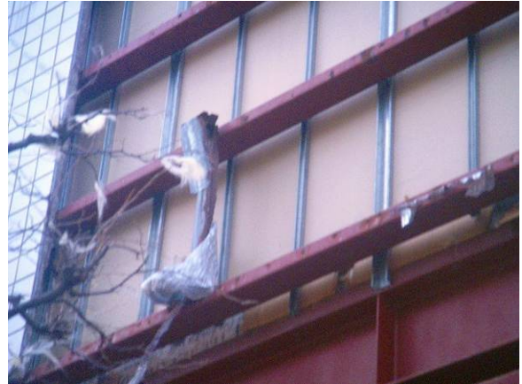
写真 48 仕上げ材の剥離状況
