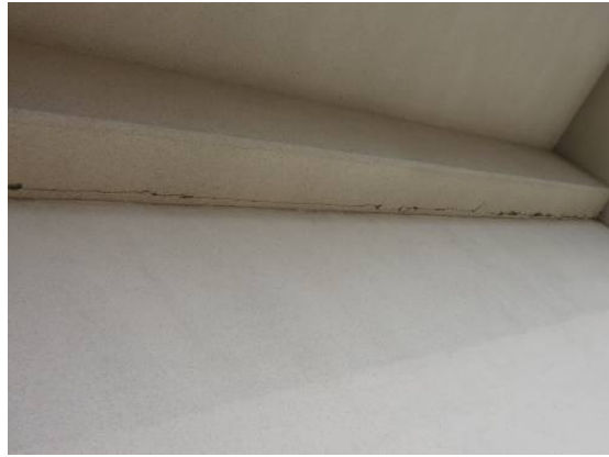
写真 14 壁と梁との接続部のひび割れ
