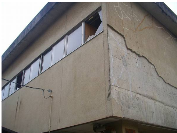
写真 70 体育館の外装被害
