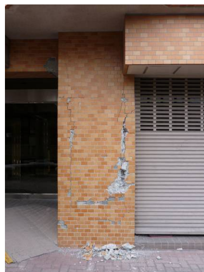
写真 36 1 階柱の付着割裂ひび割れ
