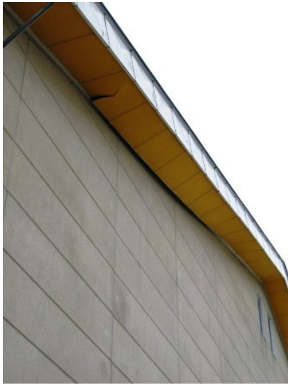
写真 13 妻面の軒天井の損傷
