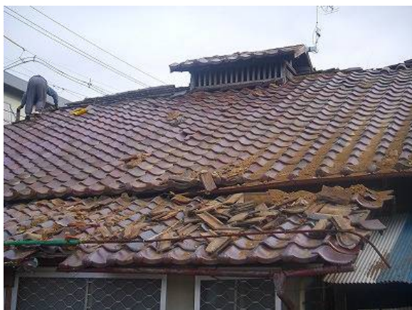
写真 59 屋根瓦のずれと葺き土の表出
