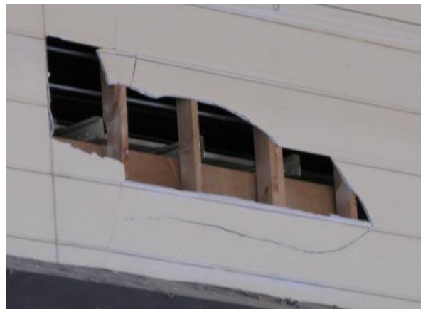
写真 10 内装仕上げ材損傷箇所の詳細
