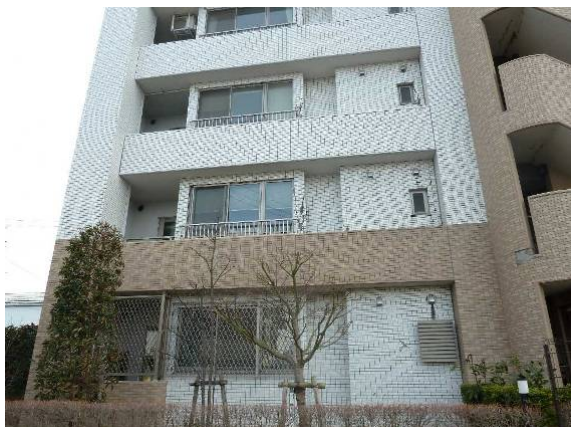
写真 24 非構造外壁の損傷
