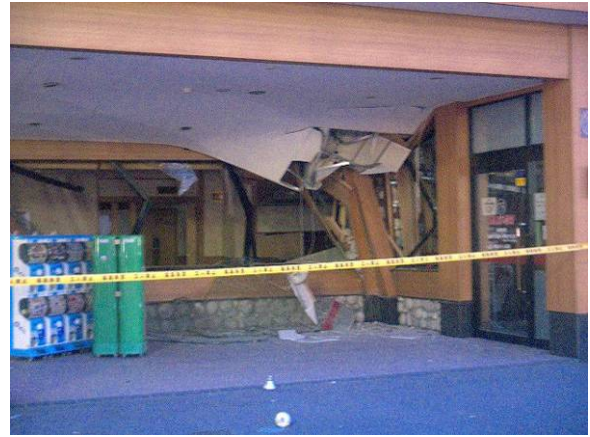
写真 51 1 階入隅部の柱と天井の破壊
