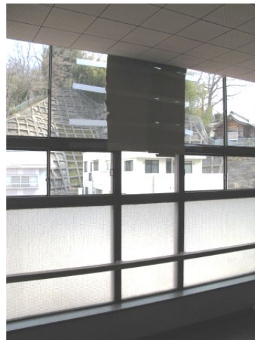
写真 2 窓ガラスの破損箇所
