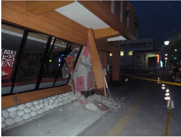
写真 50 1 階柱のせん断破壊
