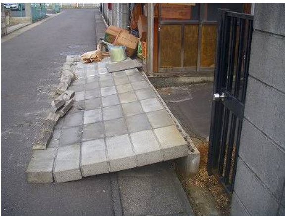
写真 57 コンクリートブロック塀の転倒
