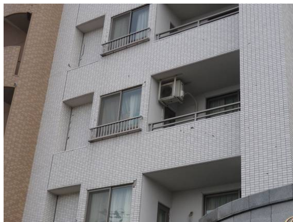
写真 25 軽微なせん断ひび割れ（梁及び柱）
