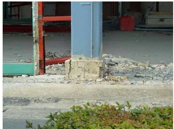
写真 40 柱脚部分の破損
