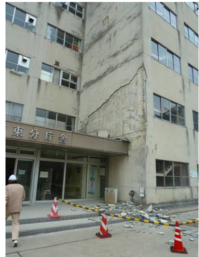
写真 64 エントランス脇の外壁仕上りの剥落
