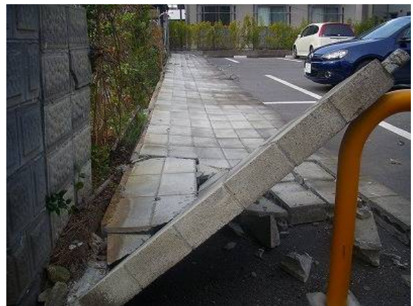
写真 58 コンクリートブロック塀の転倒
