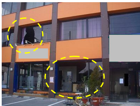
写真 31 窓ガラスの破損
