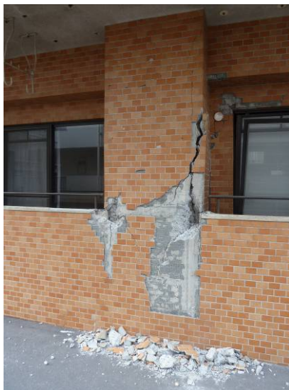
写真 35 1 階柱のせん断ひび割れ
