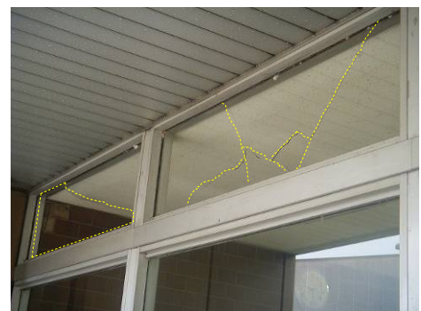
写真 65 ガラスの破損
