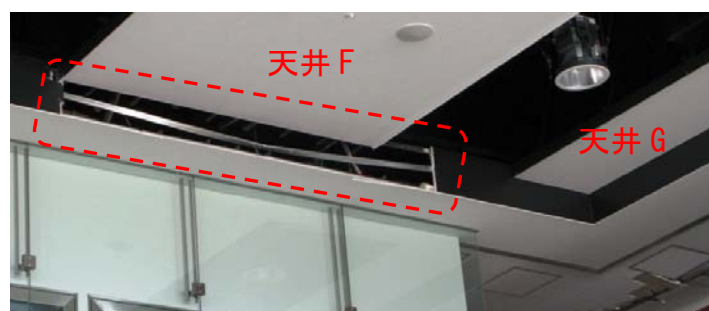
写真 7 搭乗口側の幕板の破損
