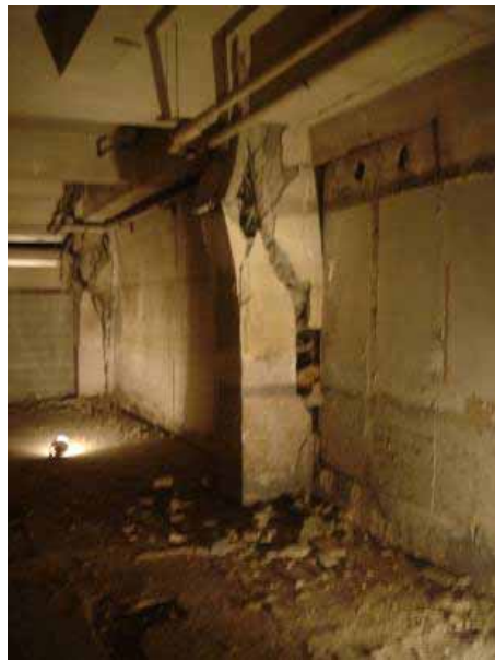
写真 14 1 階柱のせん断破壊
