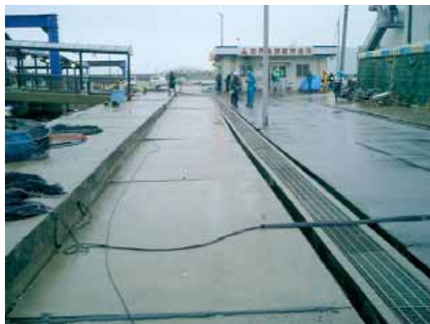
写真 26 海沿いの地盤変状
