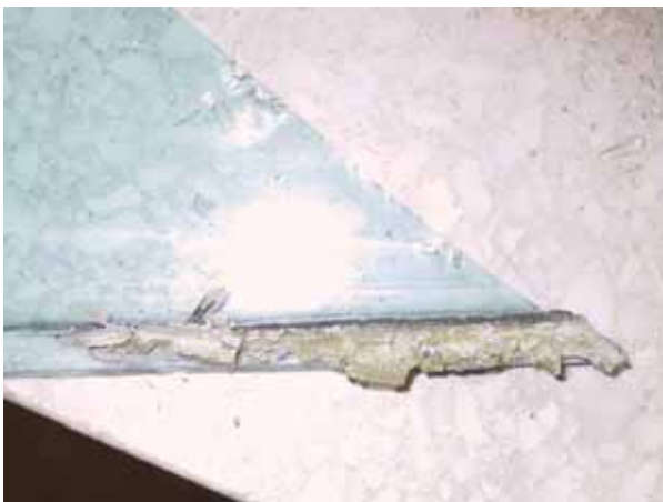
写真 3 破損したガラスと硬化性パテ
