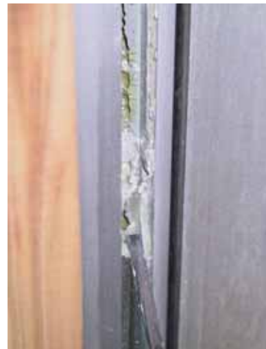
写真 4 破損したガラスと硬化性パテ
