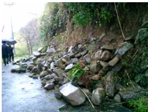
写真 50 東側海岸沿いの石積み擁壁の崩壊
