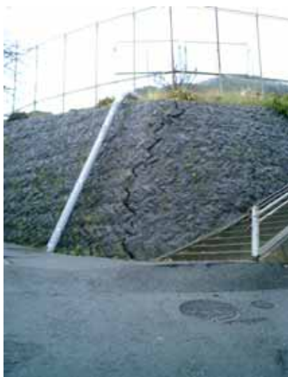
写真 49 中学校の海岸側 (擁壁と道路の割れ)
