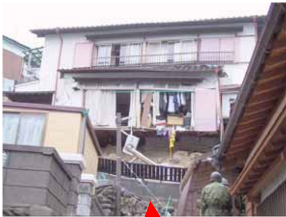
敷地地盤の破壊
