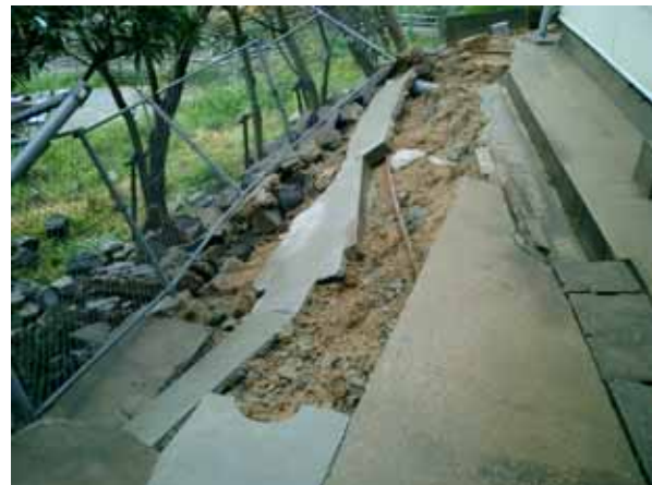
写真 42 小学校南側の斜面の崩壊
