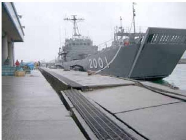
写真 25 海沿いの地盤変状
