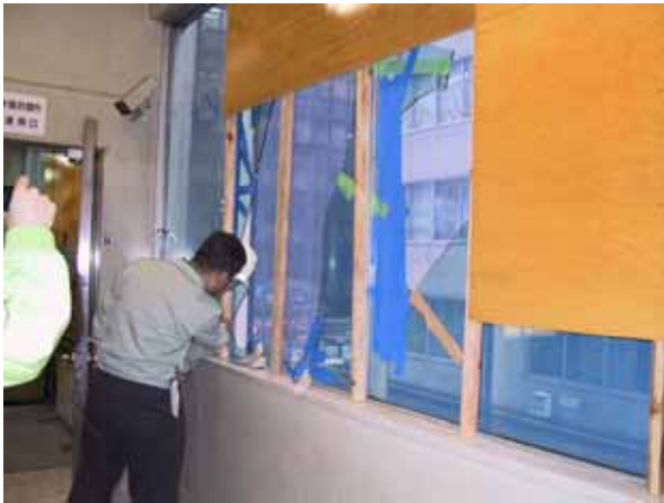
写真 1 破損した窓ガラス
