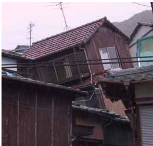
写真 27 全体的に傾いた住宅
