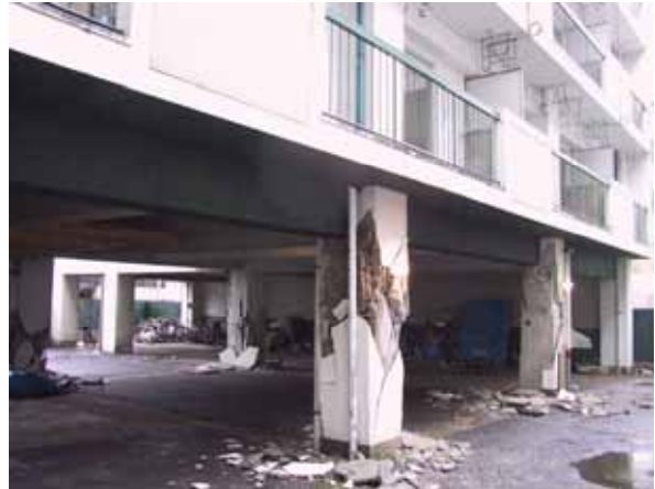
写真 11 1階ピロティ柱のせん断破壊
