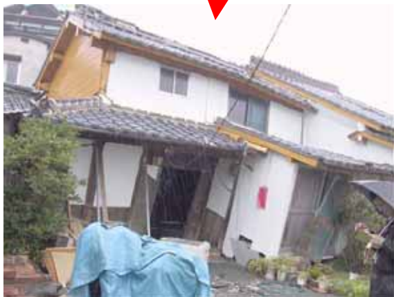
建築物の1階の著しい傾斜
