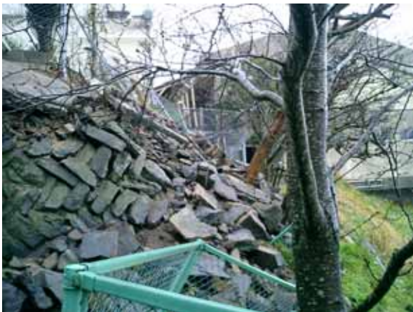
写真 41 小学校南側の斜面の崩壊
