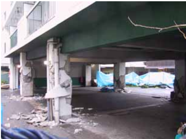
写真 10 1階ピロティ柱のせん断破壊
