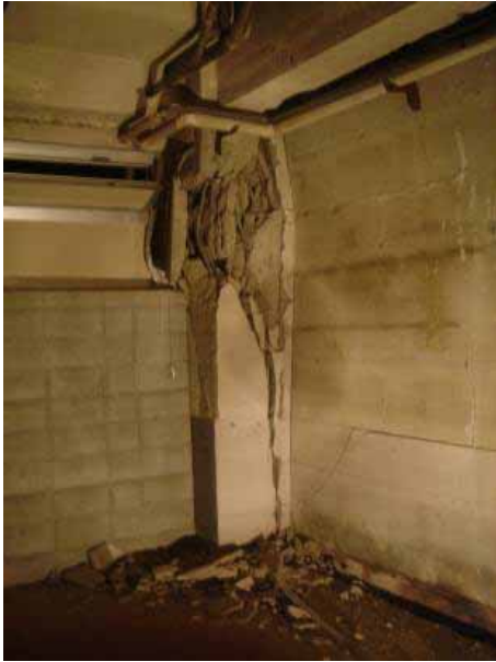
写真 13 1 階柱のせん断破壊
