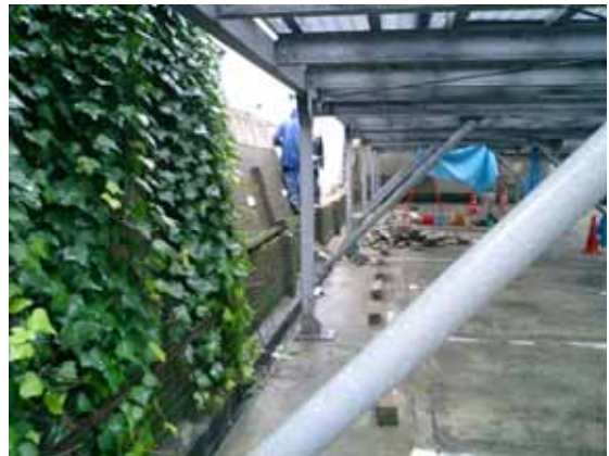
写真 19 駐車場の塀の崩壊
