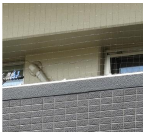
写真 3.2.34-2 非構造壁の曲げひび割れ
