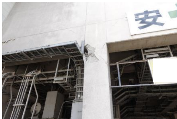
写真 3.2.3-6 建築物 Y-6 の柱頭のせん断破壊
