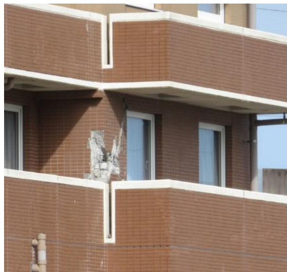
写真 3.2.43-2 柱のせん断ひび割れ、 コンクリートの剥落
