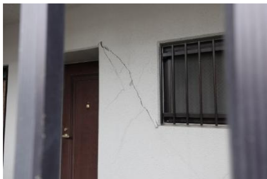
写真 3.3.5-3 廊下側の損傷
