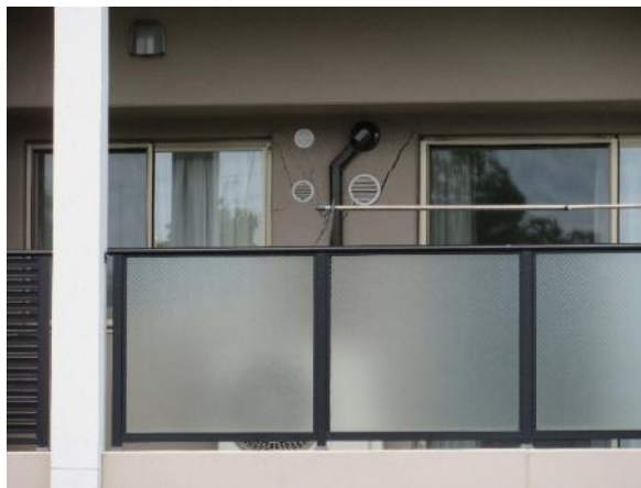
写真 3.2.30-2 非構造壁のせん断ひび割れ
