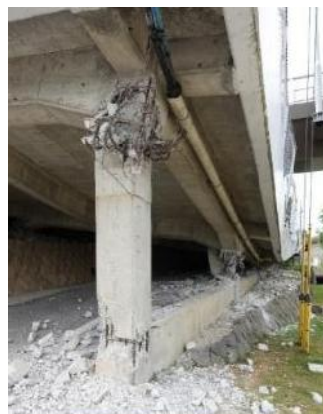
写真 3.6.2-2 RC 支柱の軸崩壊
