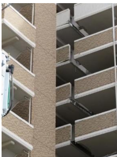
写真 3.2.29-3 Exp.J 周辺の損傷
