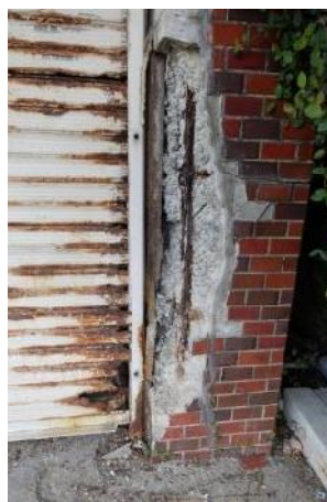
写真 3.2.47-2 柱のカバーコンクリートの剥落
