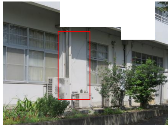
写真 3.4.4-6 1 階の柱、非構造壁の せん断ひび割れ（写真の赤囲位置）（UK-5）
