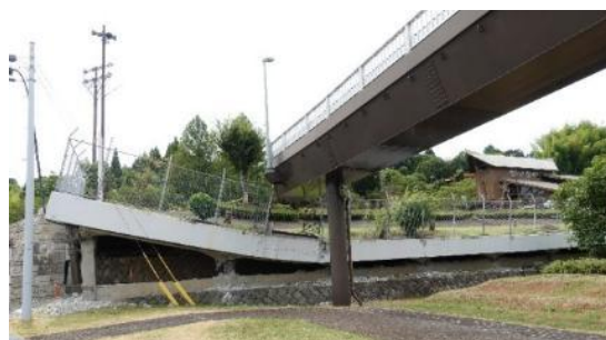
写真 3.6.2-4 天端部分の落下
