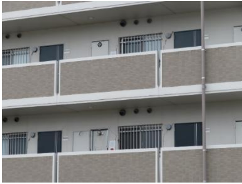
写真 3.4.10-3 廊下側の非構造壁の せん断ひび割れ
