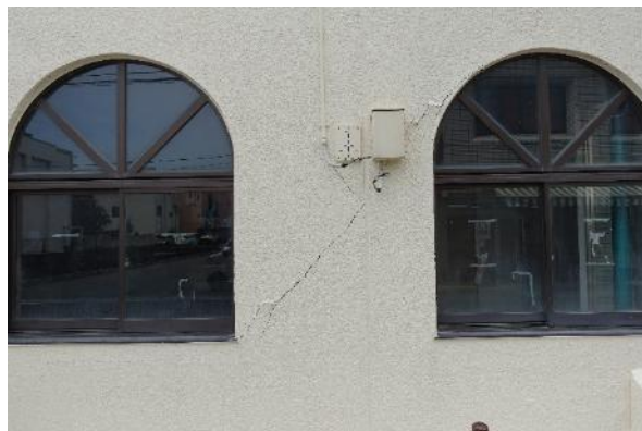
写真 3.2.7-2 窓開口間の壁のせん断ひび割れ
