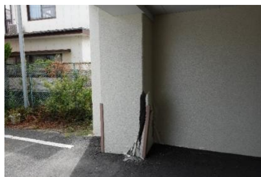
写真 3.2.24-4 柱下部の曲げ圧壊
