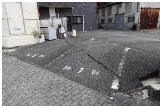
写真 3.2.45-4 建築物周辺の地盤変状
