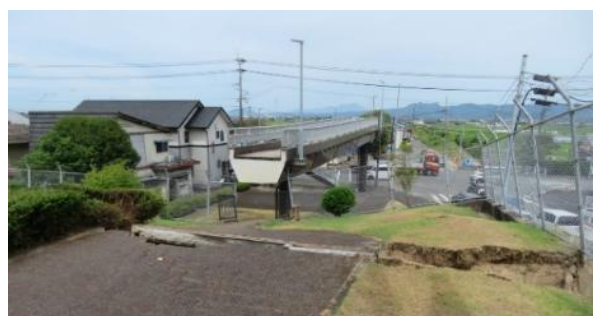
写真 3.6.2-3 天端部分の落下
