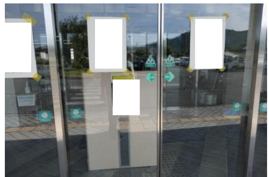
写真 3.4.3-2 自動ドアの故障
