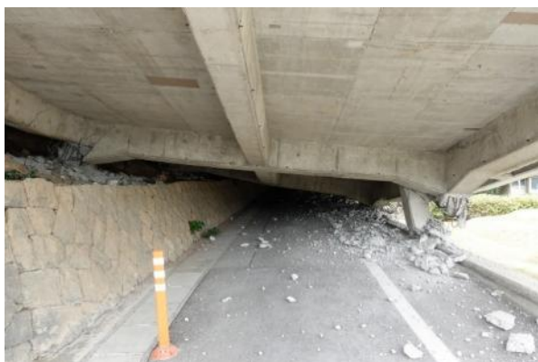
写真 3.6.2-1 天端部分の落下
