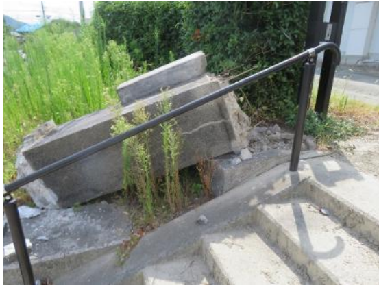
写真 3.4.4-3 門柱の倒壊（UK-4 付近）
