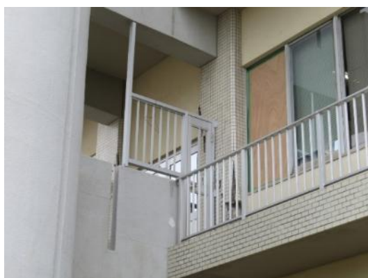
写真 3.4.2-5 2 階開口横にある柱の損傷
