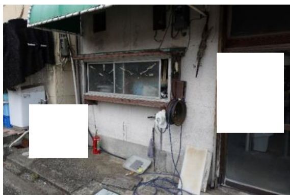
写真 3.2.47-3 窓開口周りの非構造壁のひび割れ
