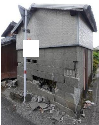
写真 3.2.49-1 建築物外観と壁の被害
