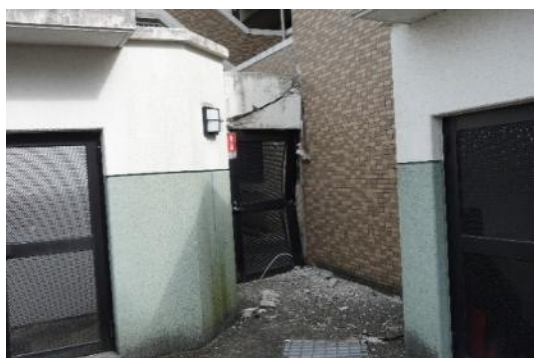
写真 3.2.29-5 入口周囲の損傷
