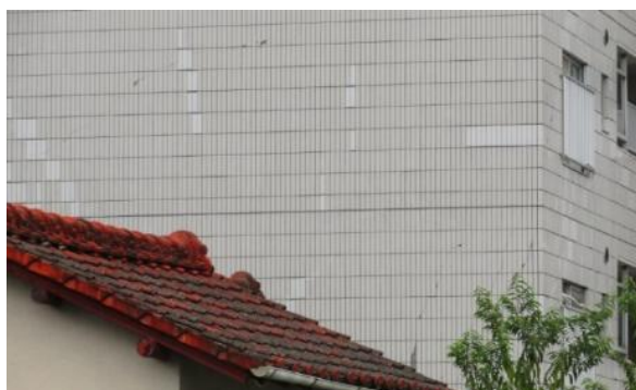
写真 3.2.25-3 耐力壁のせん断ひび割れ
