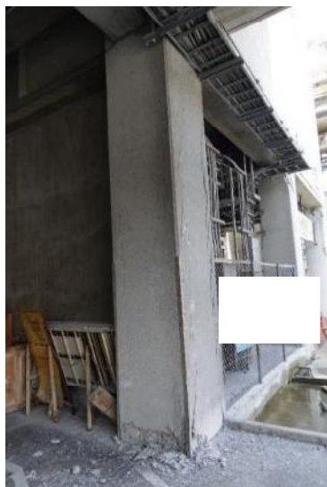
写真 3.2.3-7 建築物 Y-6 の柱の付着割裂 ひび割れ及び曲げ圧壊
