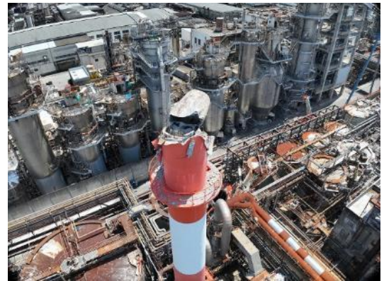
(c) 折損部断面
