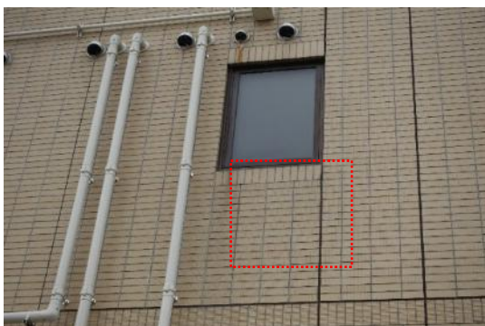
写真 3.2.5-7 窓下壁のせん断ひび割れ
