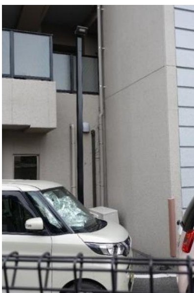
写真 3.2.30-3 非構造壁のひび割れ状況
