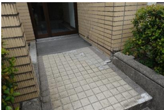
写真 3.2.5-3 裏口の床面の割れ
