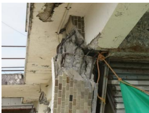
写真 3.4.5-3 1 階柱頭の損傷
