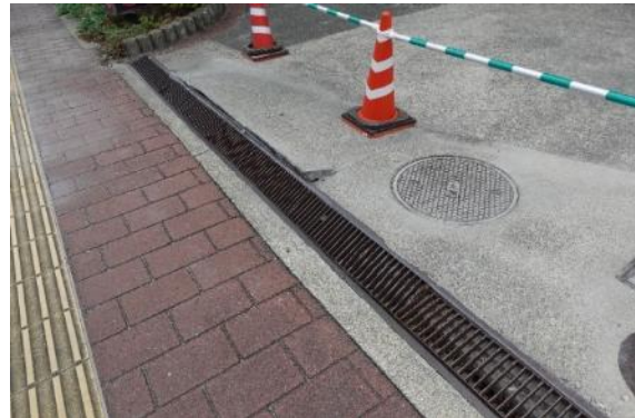
写真 3.2.41-2 周辺地盤の変状
