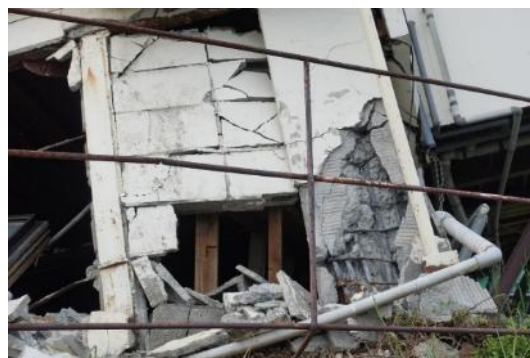
写真 3.2.6-2 1階柱脚の損傷状況
