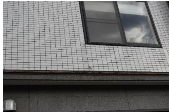
写真 3.2.37-2 外壁タイルの割れ
