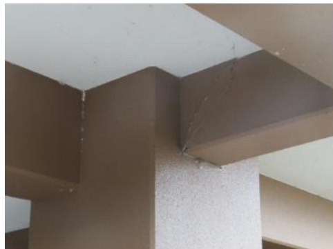
写真 3.2.31-6 突出部を支持する梁の被害状況
