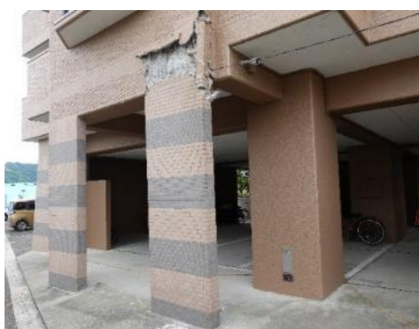
写真 3.2.31-5 突出部を支持する 壁柱頂部の被害状況
