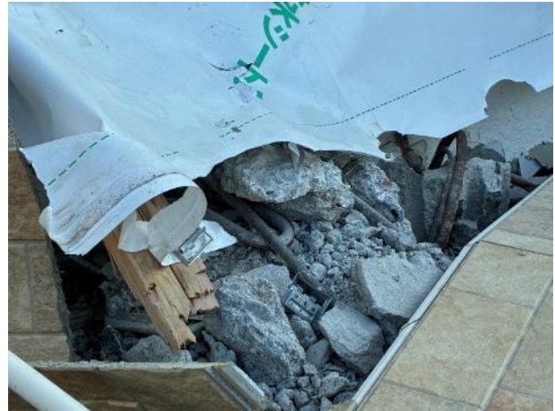
写真 3.2.2-2 崩れた柱の一部
