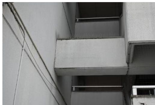
写真 3.2.14-2 境界梁のせん断ひび割れ
