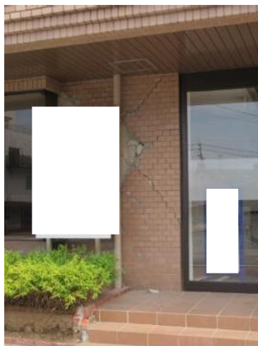
写真 3.4.6-2 1 階の非構造壁のせん断ひび割れ
