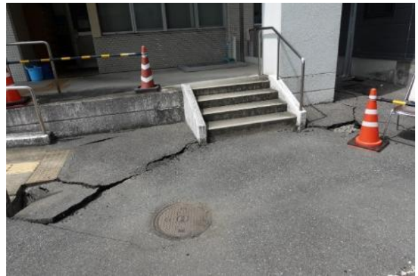
写真 3.4.2-10 エレベータホール周辺の地盤変状
