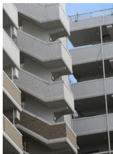
写真 3.2.29-4 階段手摺部分のひび割れ
