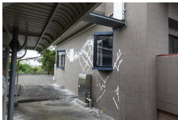
写真 3.2.17-2 妻構面耐震壁のせん断ひび割れ
