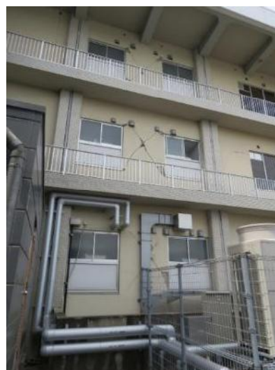
写真 3.4.2-6 各階の非構造壁のせん断ひび割れ
