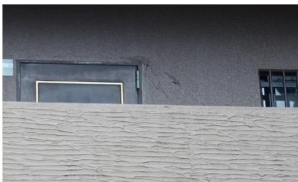
写真 3.2.32-3 方立壁の被害
