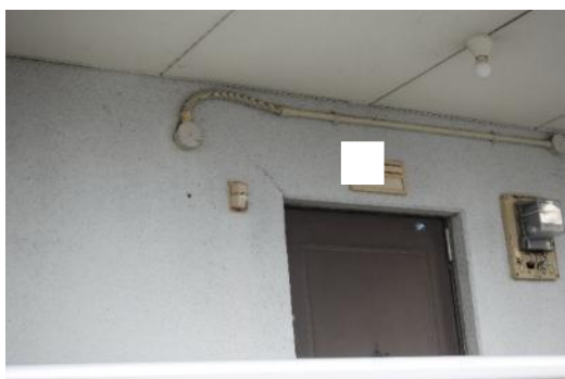
写真 3.2.14-3 方立壁のせん断ひび割れ
