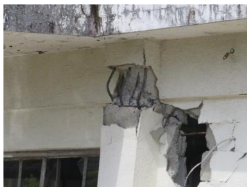
写真 3.4.5-4 1 階柱頭の損傷
