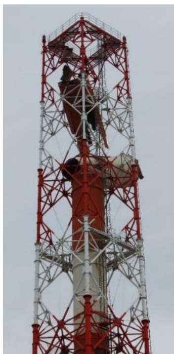
(a) 円筒頂部の折損部
