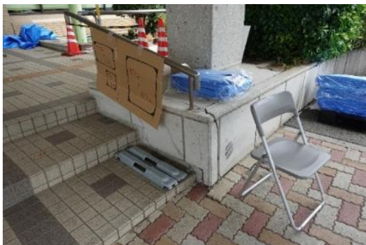
写真 3.2.5-5 入口ポーチ周辺の割れ
