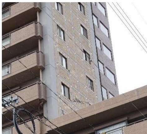
写真 3.2.32-2 妻構面の壁の せん断ひび割れ等の被害
