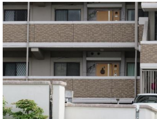
写真 3.2.29-2 方立壁のせん断破壊
