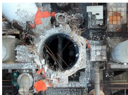
(c) 折損部断面
