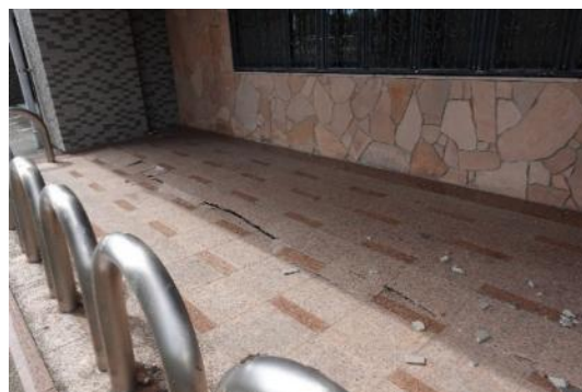
写真 3.2.28-4 周辺地盤変状の状況
