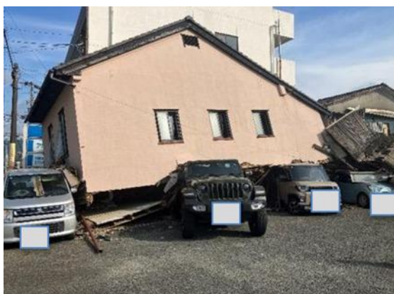
写真 8.2.21 1層の事務所が崩壊した建物
