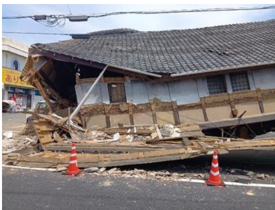
写真 7.2.11 木造住宅の倒壊
