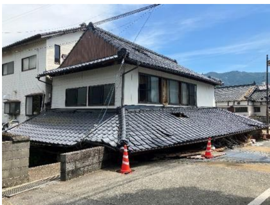
写真 7.2.1 木造住宅の1層崩壊
