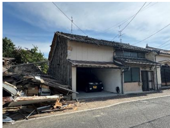
写真 8.2.6 同年代の隣接住宅（倒壊なし）
