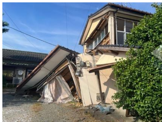
写真 7.2.2 木造住宅の倒壊
