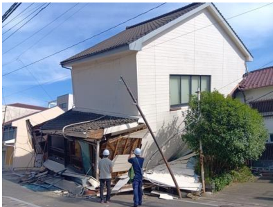
写真 8.2.1 倒壊した 3F 建て木造住宅
