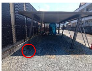
写真 6.2.8a カーポートの変形
