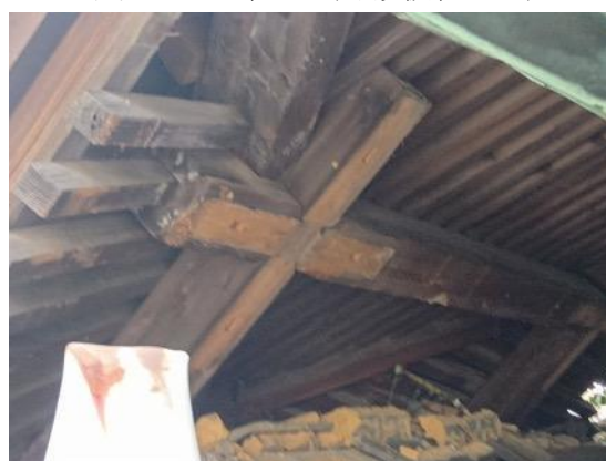
写真 8.2.16 肘木や桁がはずれた様子
