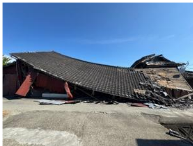
写真 5.2.10a 倒壊した納屋
