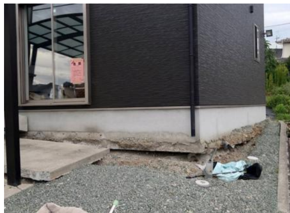
写真 A.2 地盤沈下に伴う基礎周辺の地盤変状 (国土技術政策総合研究所三木氏提供)
