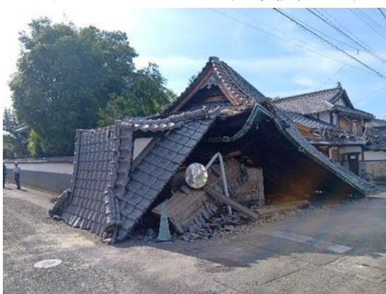
写真 8.2.15 社寺建物の倒壊
