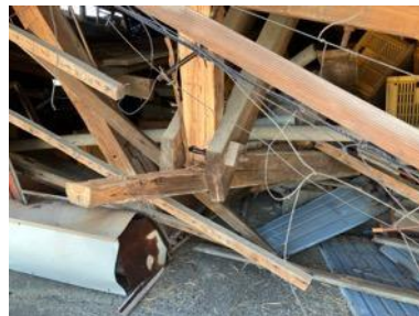
写真 5.2.10b 釘うちのみで接 合された筋かい
