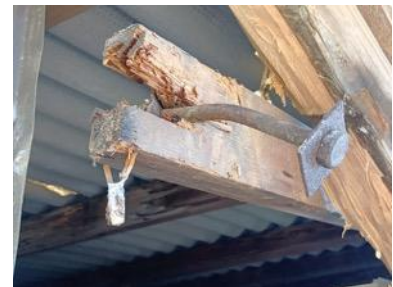
写真 5.2.10c 変形した羽子板 ボルト
