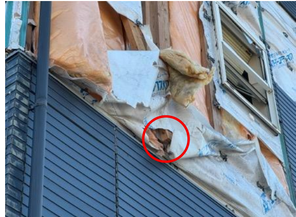
写真 5.2.9b 露出した筋かい端部金物
