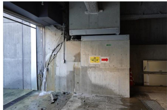
図 4.1.1-8 免震ピット立上り壁の被害
