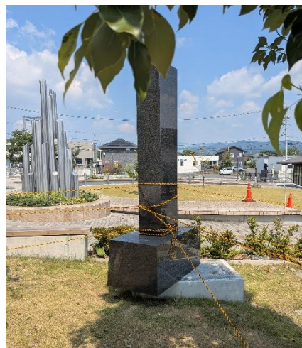
図 4.2.3-7 モニユメントの基部からのずれ
