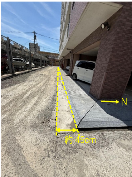
図 4.1.3-3 建物奥側（東側）のカバーのずれ
