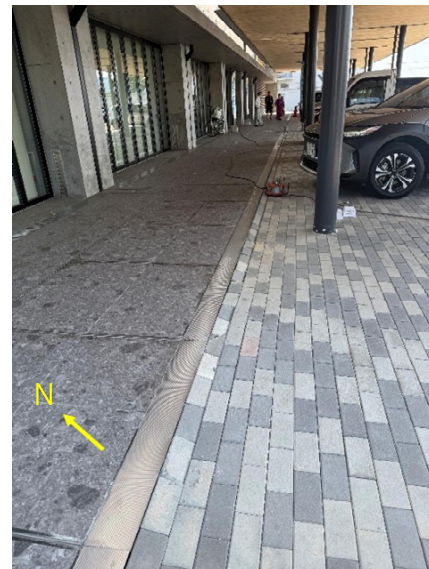
図 4.2.1-7 エキスパンション部の変状
