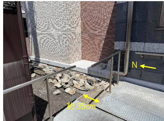
図 4.1.3-2 手すりとエキスパンションカバーのずれ（西側）
