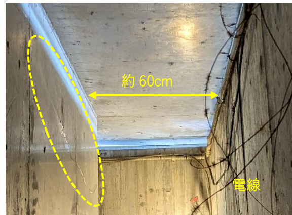
図 4.1.2-2 免震上部基礎と擁壁との接触痕
