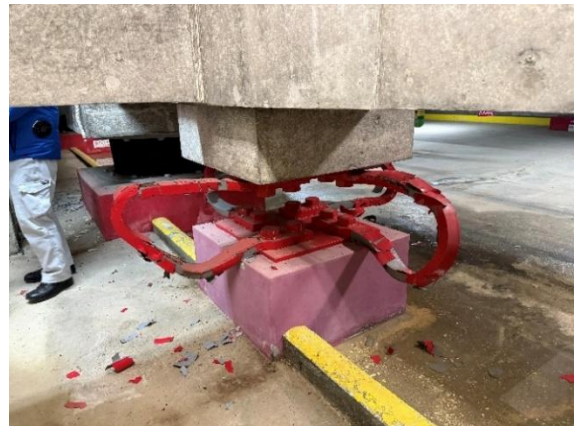
図 4.1.2-4 鋼材ダンパーの変形と塗装の剥がれ
