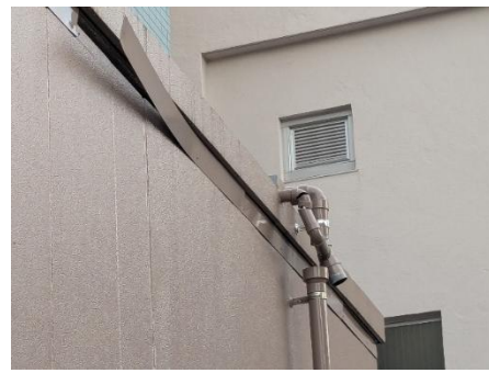
(d) カバーの変形及び雨どいの脱落
