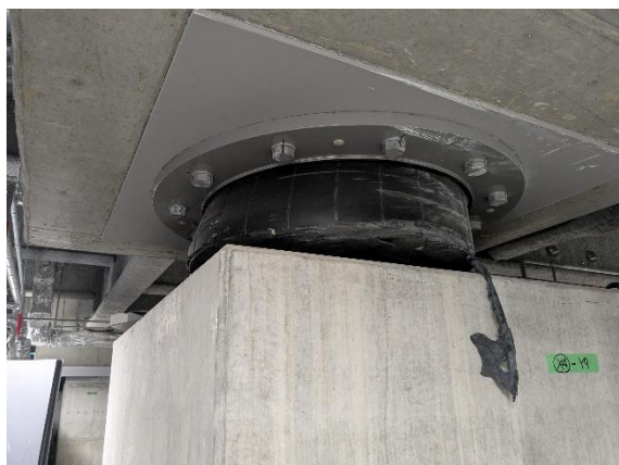
図 4.1.1-4 支承材の積層ゴム部の被害
