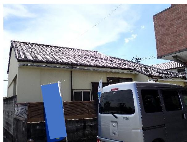
写真 2.2.8 棧瓦のずれと脱落
