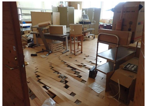
写真 2.1.6 床面の連続した亀裂
