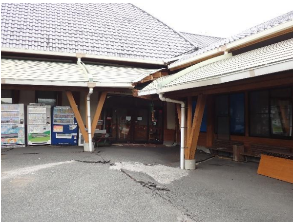
写真 2.1.3 地盤変状と屋根の分離
