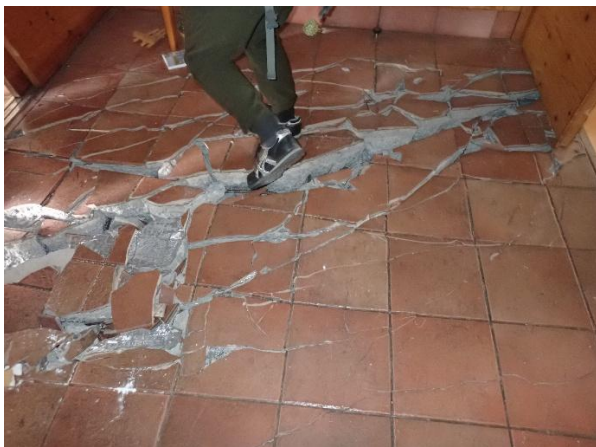
写真 2.1.5 床面の連続した亀裂
