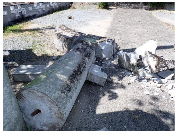
写真 3.4 鳥居の倒壊（宇城市松橋町松橋）
