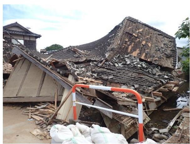
写真 2.3.4 屋根の崩落被害
