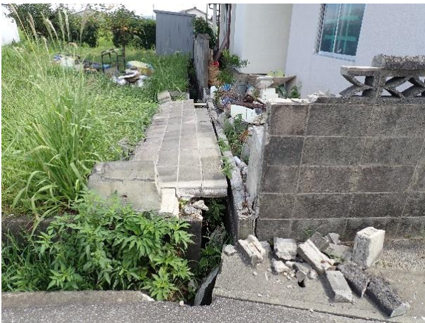
写真 3.3 ブロック塀の倒壊（氷川町新田）
