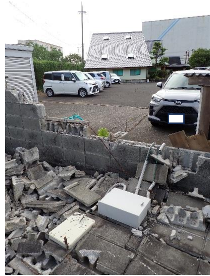
写真 3.2 ブロック塀の倒壊（八代市日置町）
