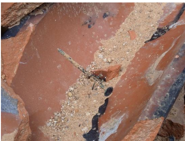
写真 2.3.6 棟瓦に連結されていた釘の状況
