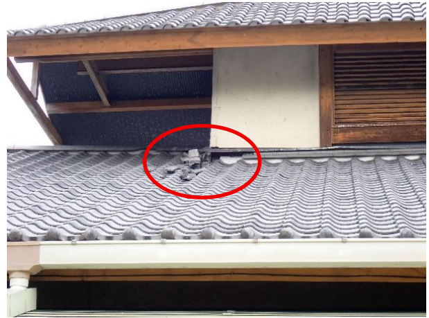
写真 2.1.8 一部の瓦の被害
