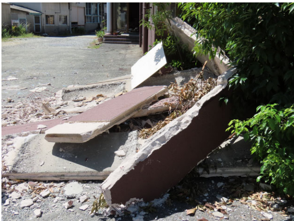
写真 UK-09-c 脱落した ALC パネル
