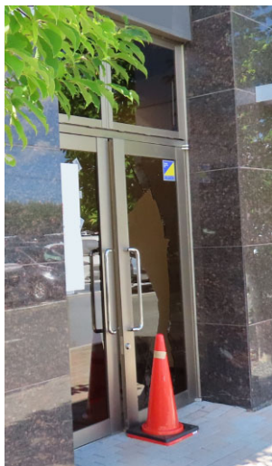
写真 UK-05-c 別棟のガラス被害
