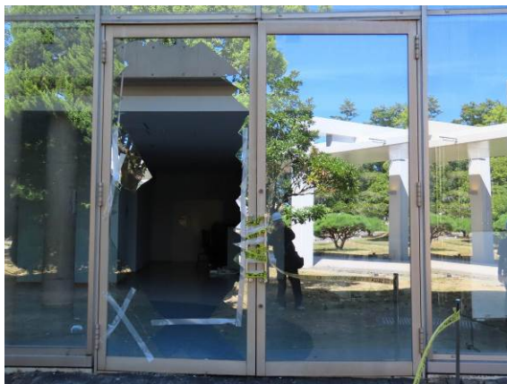
写真 UK-06-c ガラス扉の被害状況 (写真 UK-06-a の奥の扉)
