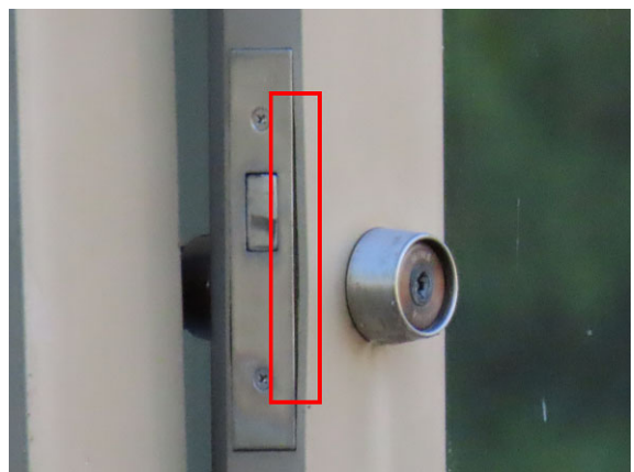
写真 UK-06-d デッドボルト周辺の被害状況 (写真 UK-06-a の手前の扉)
