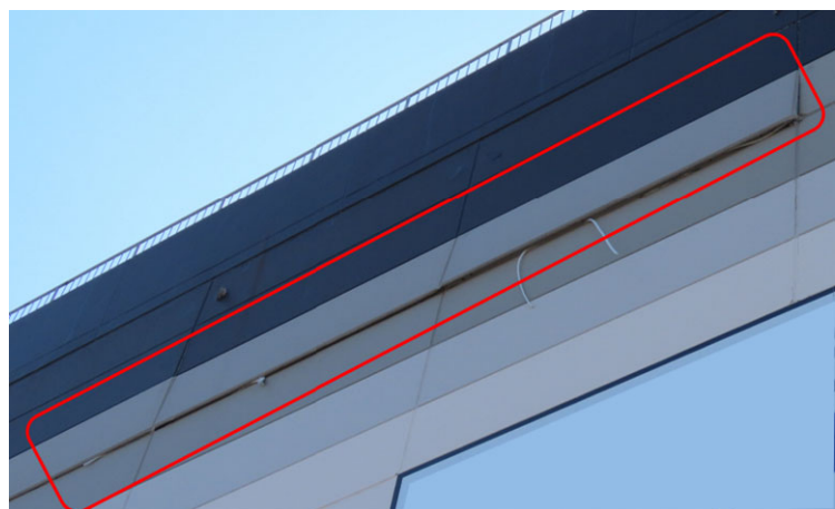
写真 YA-04-b ALC パネルの被害状況
