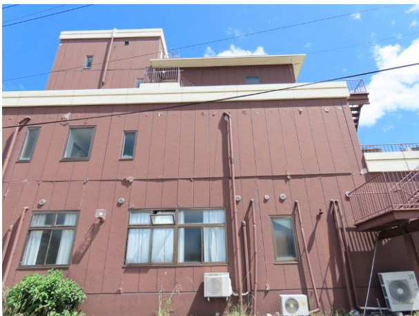
写真 UK-09-e 南面の被害状況
