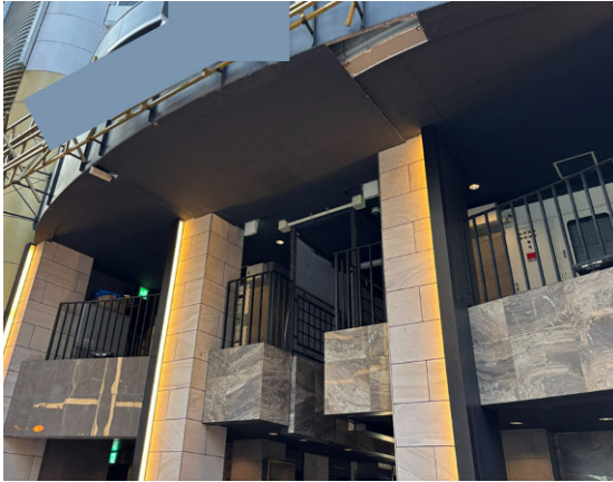
写真 KU-02-a 軒天井の被害状況
