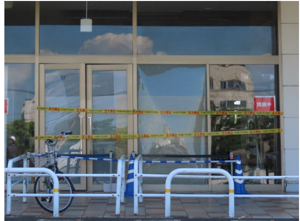
写真 YA-03-d 北側の扉の傾き
