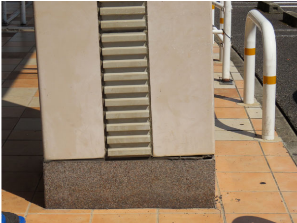
写真 YA-03-c 柱の外装材の傾き
