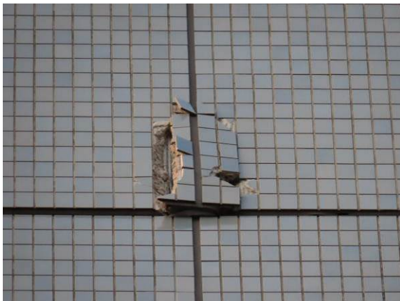
写真 KU-01-c 目地部の被害状況
