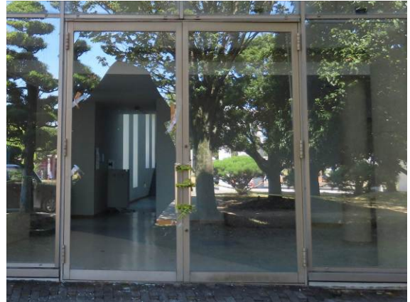
写真 UK-06-b ガラス扉の被害状況 (写真 UK-06-a の手前の扉)
