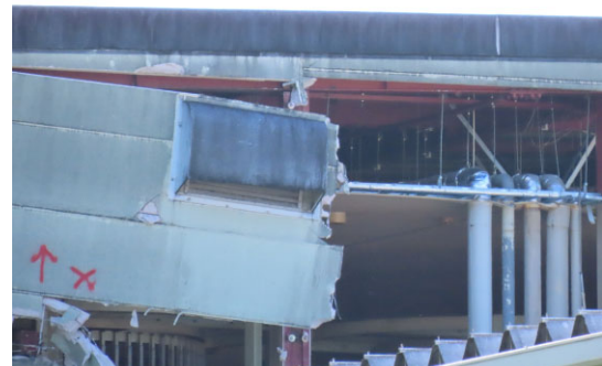
写真 UK-02-b 外壁パネルの被害状況 ※写真 UK-02-a の赤枠部分の近接写真
