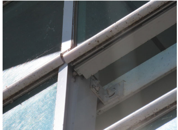
写真 YA-01-d 枠材のズレ ※写真 YA-01-c の赤丸部
