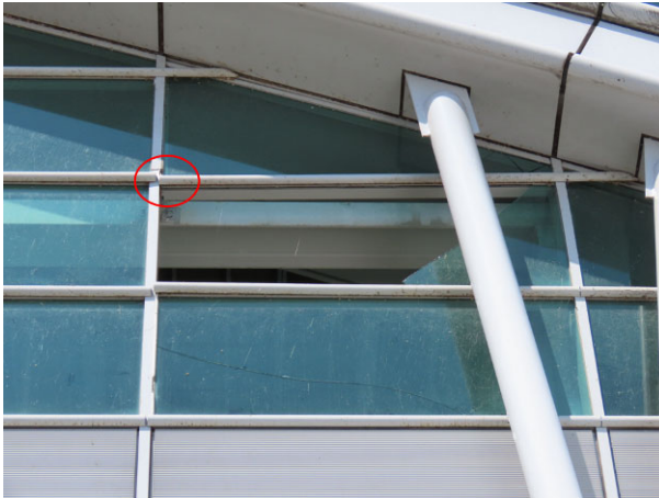
写真 YA-01-c ガラスと枠材の被害 ※写真 YA-01-b の A 部
