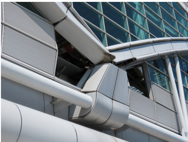
写真 YA-01-e 外壁パネルの脱落 ※写真 YA-01-b の B 部
