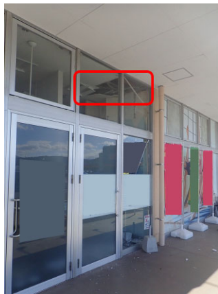
写真 UK-03-c 柱周囲の天井の脱落
