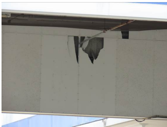
写真 UT-01-c 垂れ壁の内装材の脱落
