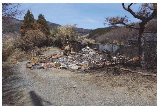
図 8.3.2 建物被害の様子（地点①）
