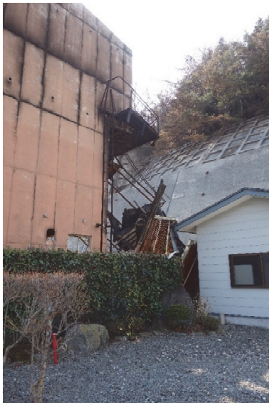
図 8.1.13 火災後の現地の様子（地点⑩） 建物山側の外壁構造（燃え止まり）
