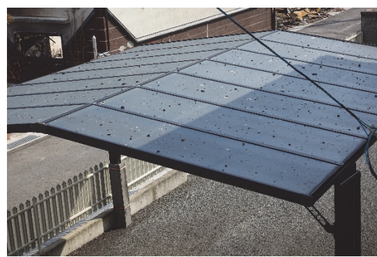
図 8.1.20 火災後の現地の様子（地点⑯）カーポート屋根に残る燃えさし
