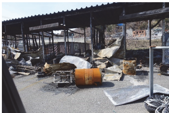
図 8.3.9 建物被害の様子（地点⑧）
