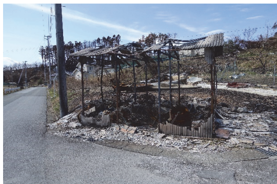
図 8.7.20 簡易な構造物の被害（地点⑱）
