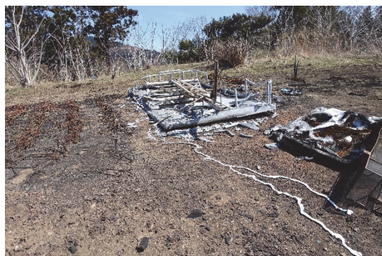
図 8.7.19 簡易な構造物の被害（地点⑱）
