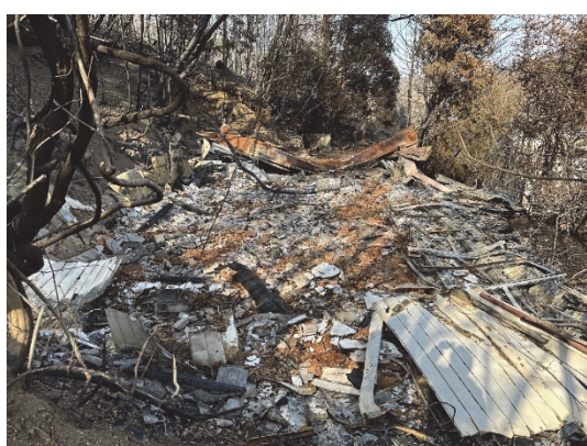
図 8.2.5 建物④の焼損状況
