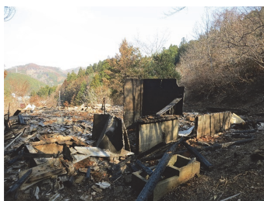
図 8.2.6 建物⑤の焼損状況
