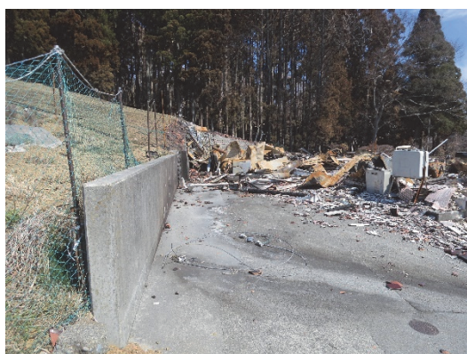
図 8.7.4 地区北側に近接した被害状況と山林の様子（地点③）
