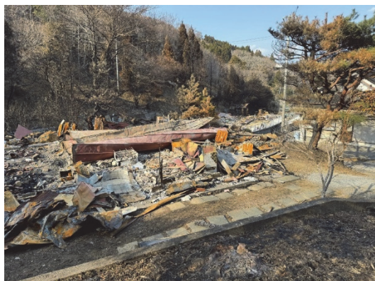
図 8.2.7 建物⑥の焼損状況
