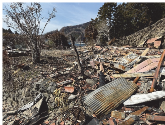
図 8.4.3 建物②の焼損状況
