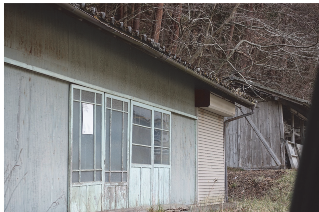
(b) 現地調査による判定（無被害）
