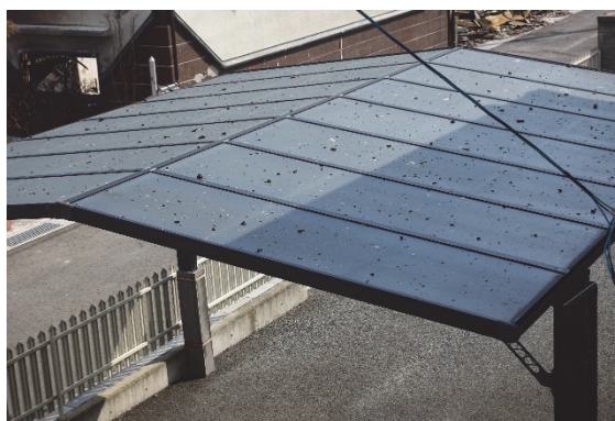
図 8.8.1 カーポート上の燃えさしの状況 (綾里港地区の延焼していない住宅)
