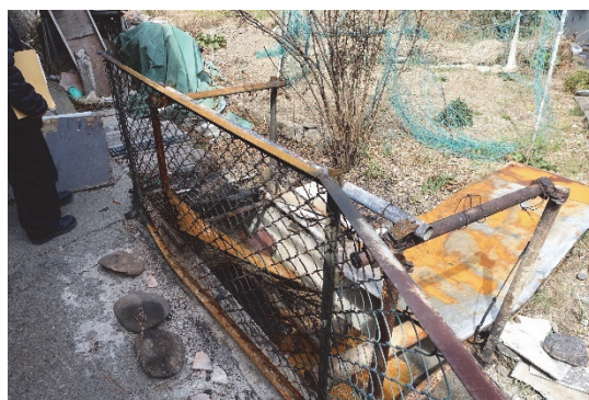
図 8.7.21 住宅が比較的密集した地域の物置の焼損跡（地点⑳）
