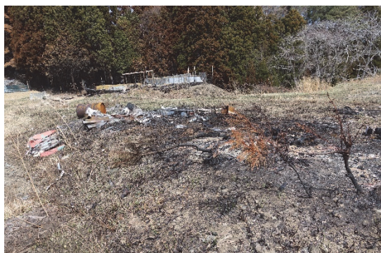
図 8.7.18 簡易な構造物の被害（地点⑰）
