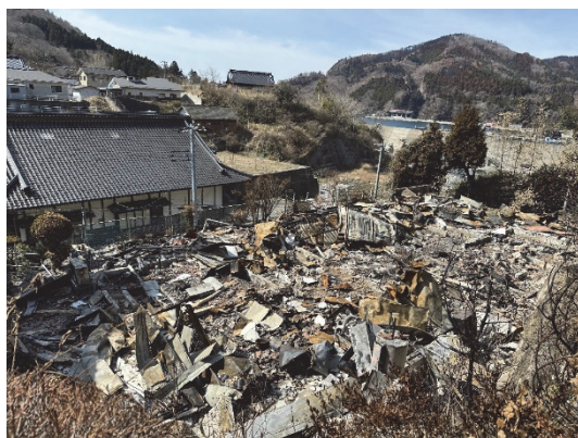
図 8.4.2 建物①の焼損状況
