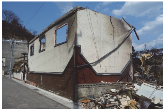
図 8.1.9 火災後の現地の様子（地点⑥）
