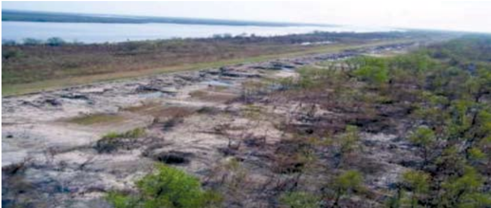
図-7.12 跡形もなく流失した Mississippi River-Gulf Outlet の堤防
