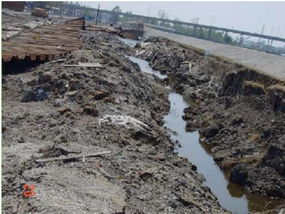
図-7.9 Industrial Canal 東岸の南側のトウォールの破堤
