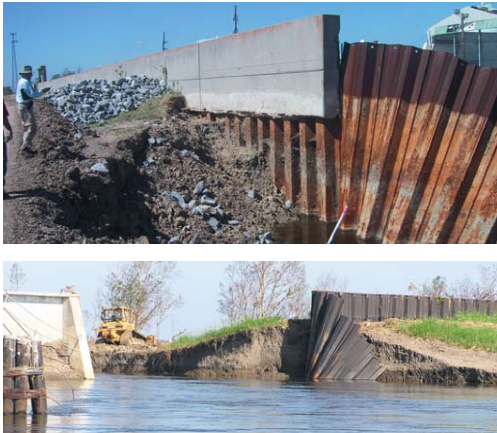
図-8.3 トウォールと堤防の破堤部
