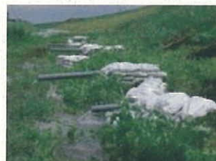
河川堤防の漏水
