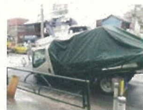
埋設管破損による道路陥没
