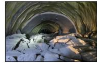
(トンネル内部の覆工崩落例)
