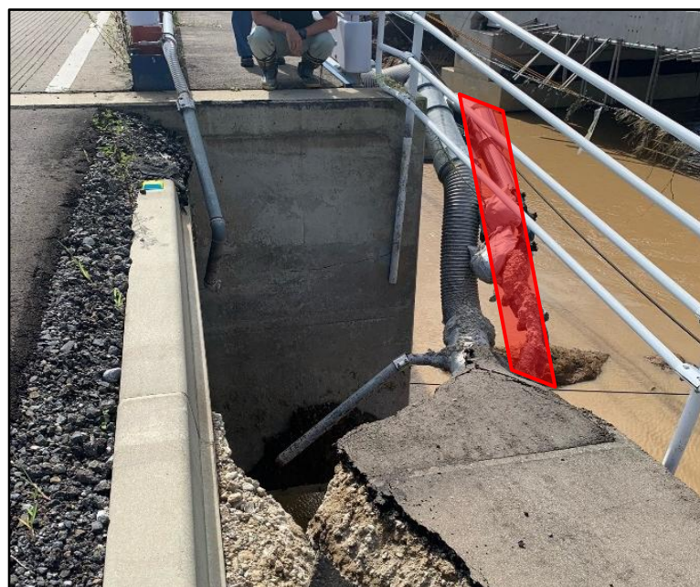
下水道管きょ損傷状況 (若山処理区広栗橋)
