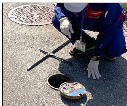
止水栓被災状況調査
