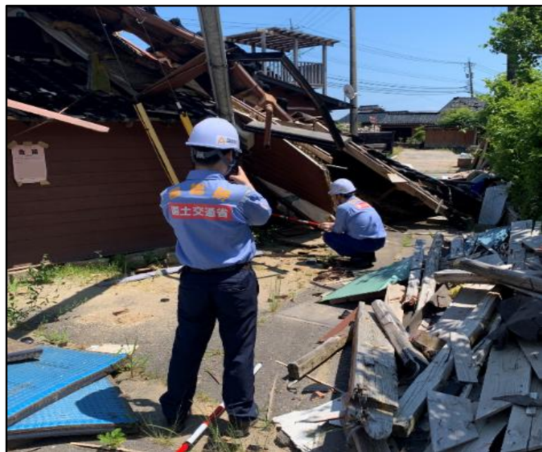
マンホールポンプ操作盤損傷状況調査 (宝立処理区春日野地区)
