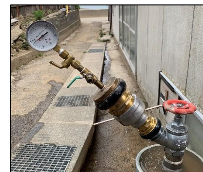
管内圧力計測
