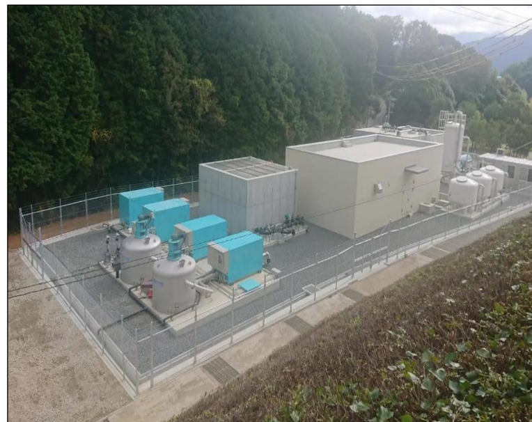
設備再設置が可能な可搬型浄水施設
