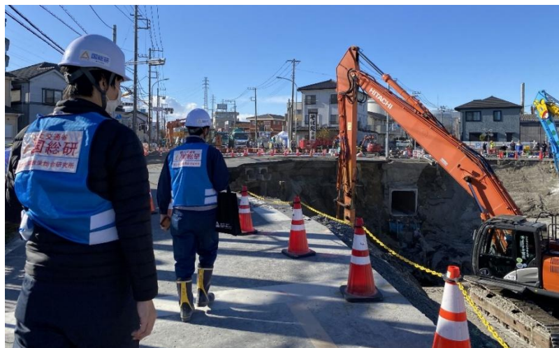
陥没現場(2月8日)
