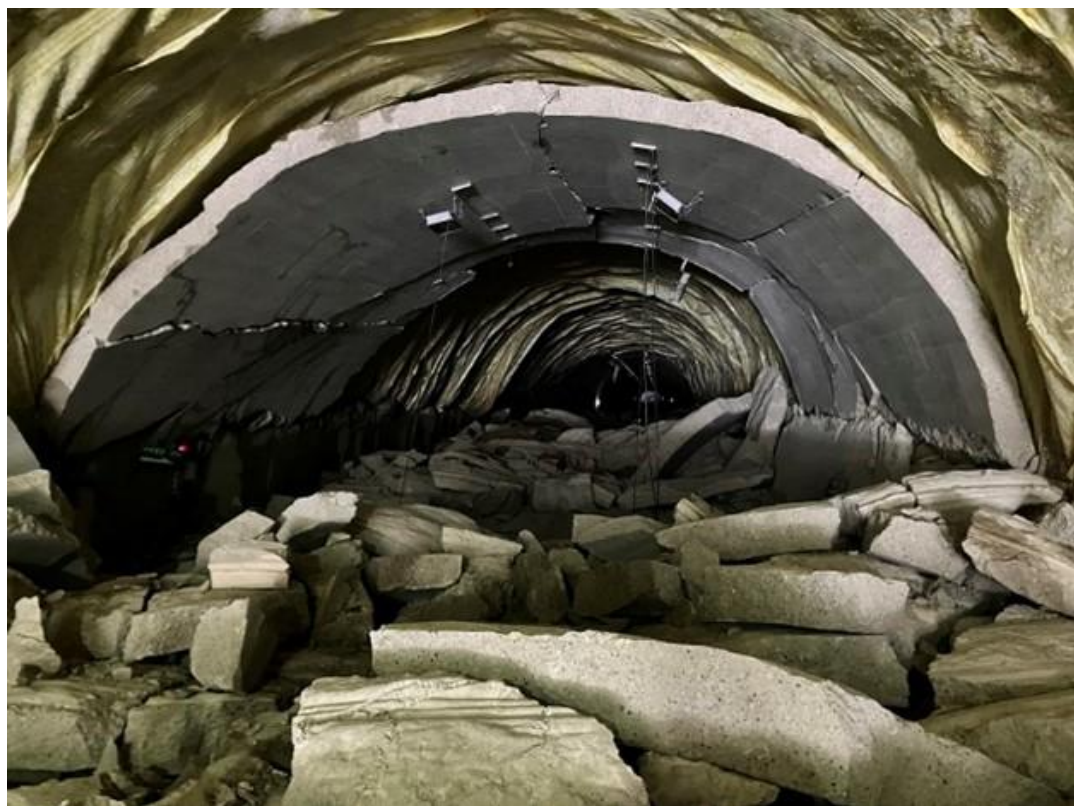
R6年能登半島地震での覆工コンクリート崩落例
