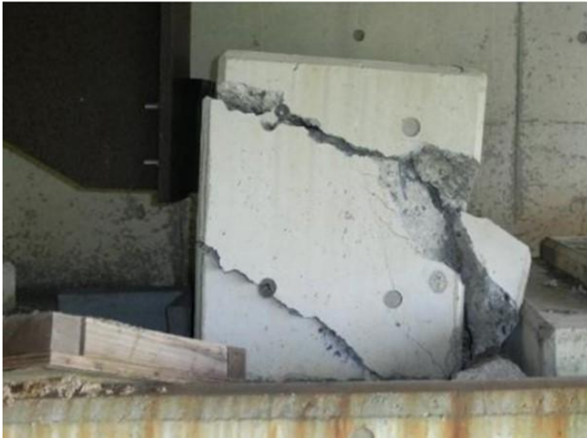
落橋防止構造(横方向の固定ブロック)の損傷
