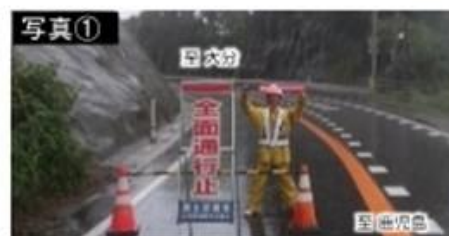
▲写真① 国道220号における規制 (伊比井地区)
