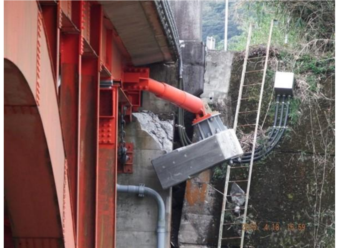
ダンパー取付部の損傷
