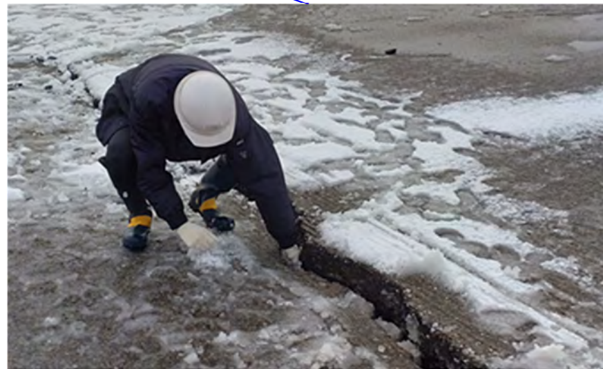
最大15cmの段差が発生
