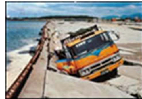
秋田港 大浜地区の陥没
