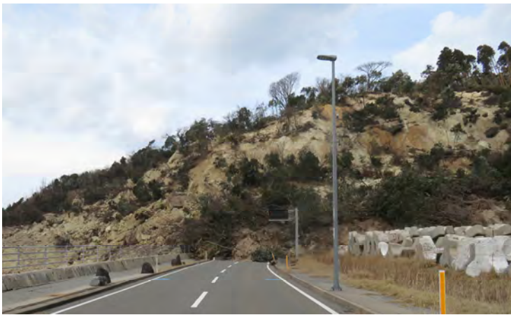
地すべり・斜面崩壊（R249逢坂トンネル坑口斜面）
