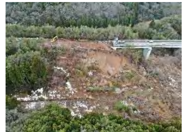
橋に接続している沢埋めの高盛土被災 （のと里山海道能登大橋南側）
