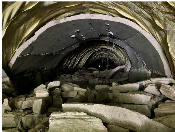
覆工コンクリート崩落（R249大谷トンネル）
