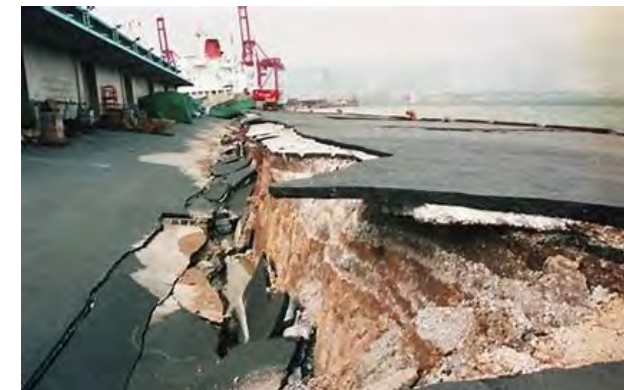
神戸港の重力式係船岸の被害
