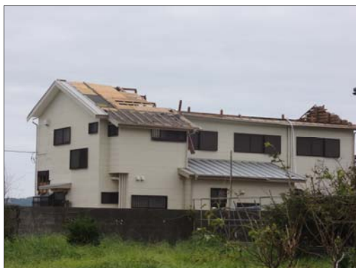
木造住宅の小屋組の飛散 (9月12日)
