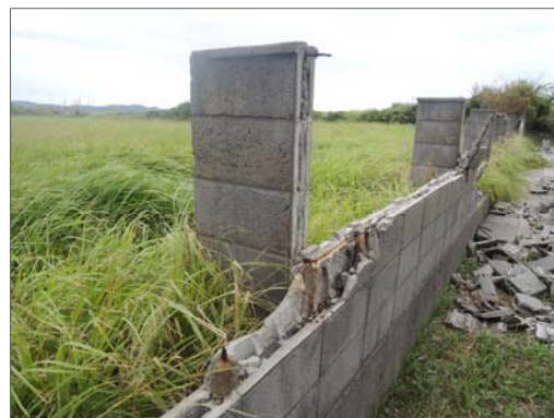
ブロック塀の倒壊 (9月12日)
