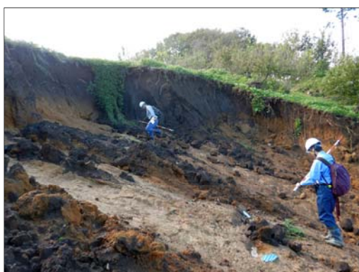
発生箇所の状況（10月15日）
