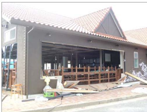
低層店舗の屋外に面する建具等の損壊 (9月12日)
