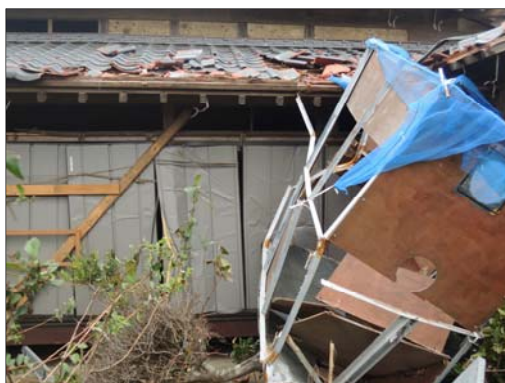
低層店舗の屋外に面する建具等の損壊 (10月15日)
