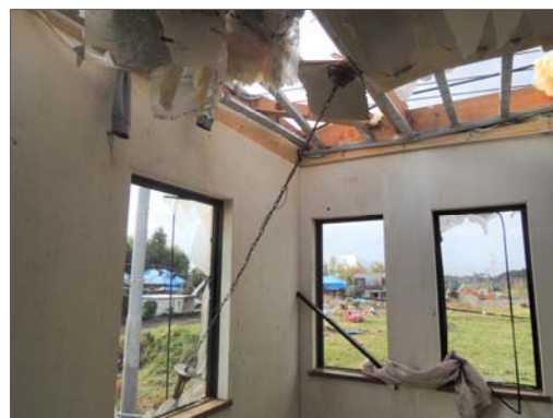
住宅内部の被害 (10月15日)
