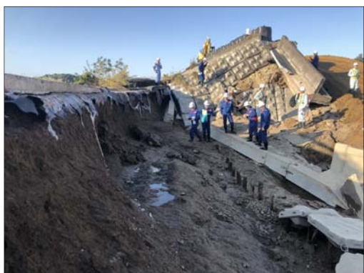
鳴瀬川水系吉田川の堤防決壊状況 (10月16日)
