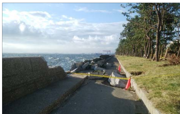
金沢地区(福浦)東側護岸上部工の被災状況 (9月14日)
