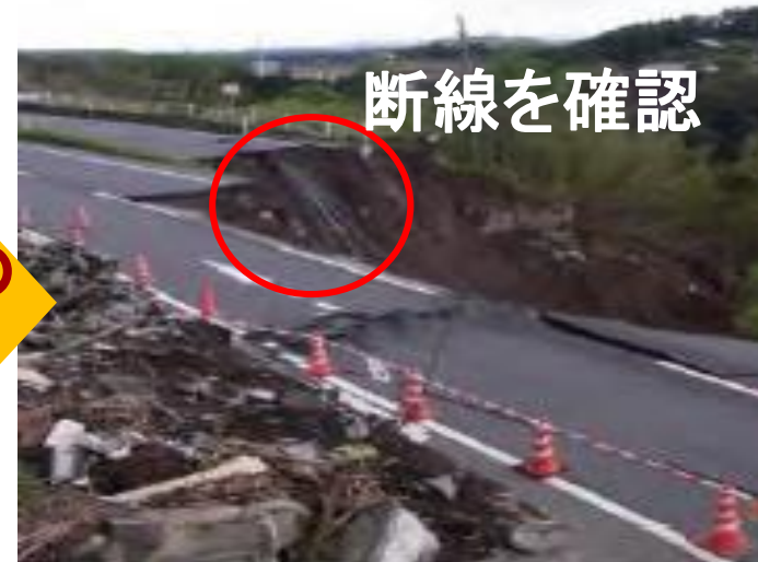
光ファイバ断線箇所 (国道57号立野地区)
