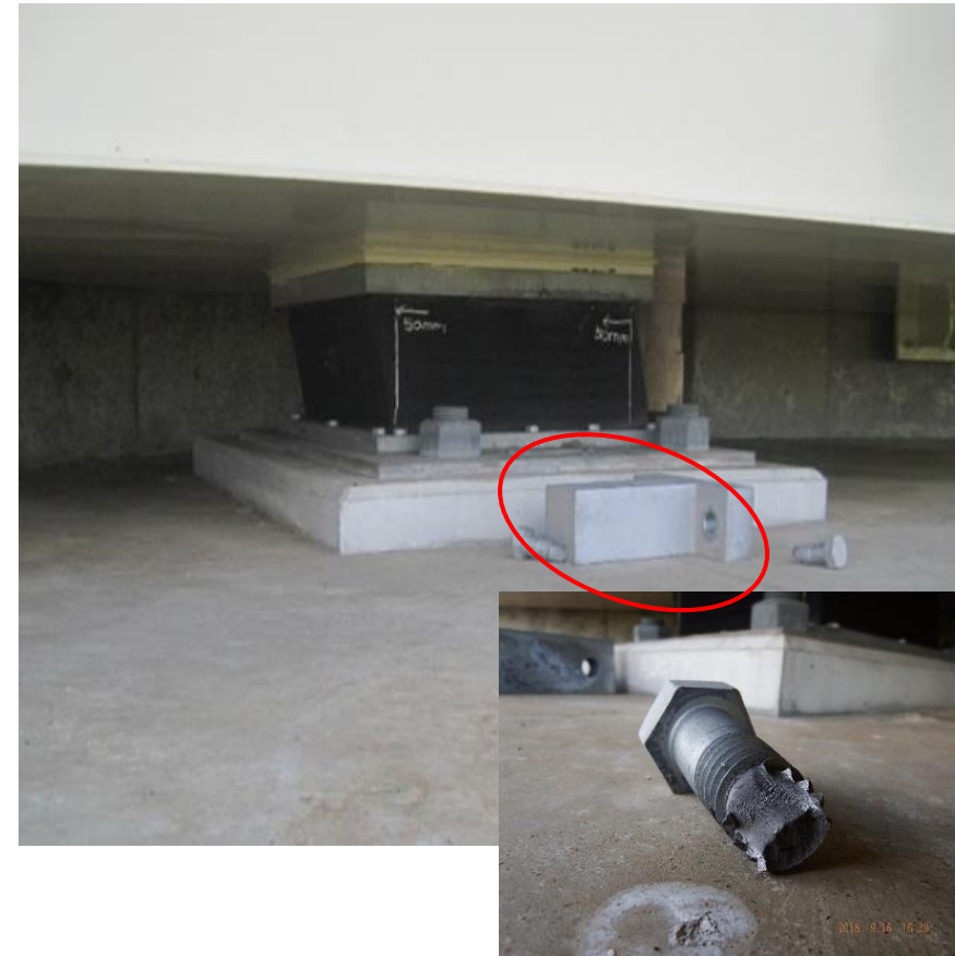
ゴム支承の残留変位、固定装置のボルト破断：あけぼの橋
