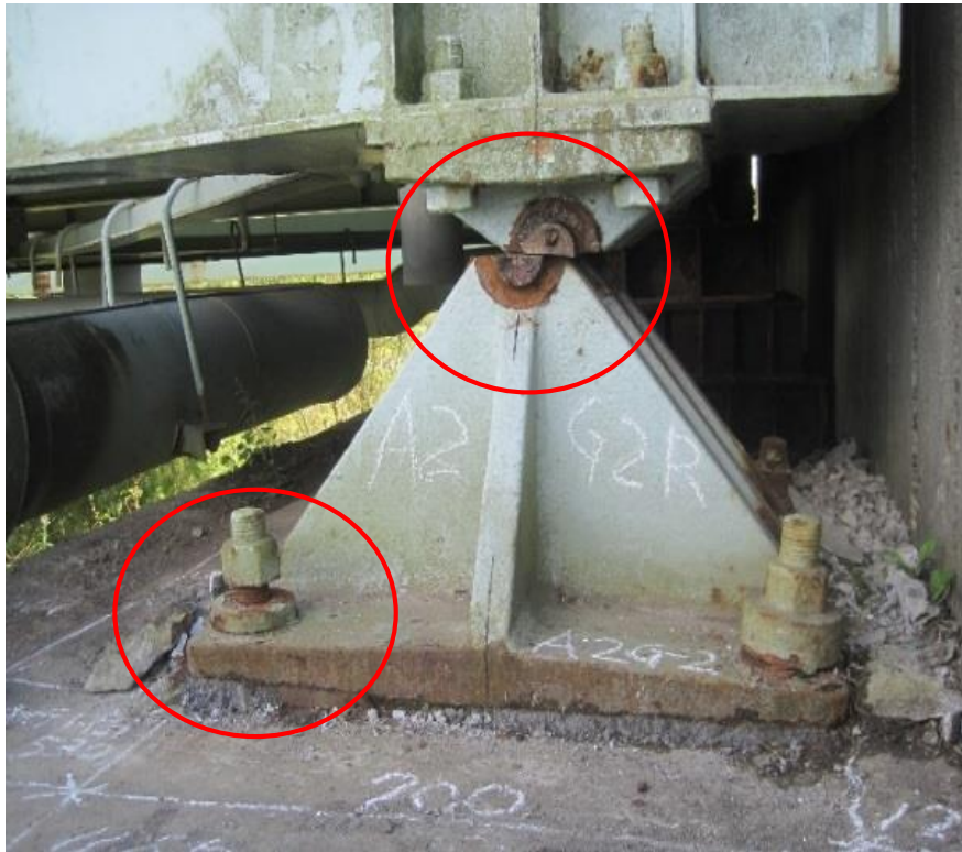
鋼製支承の損傷：上厚真大橋
