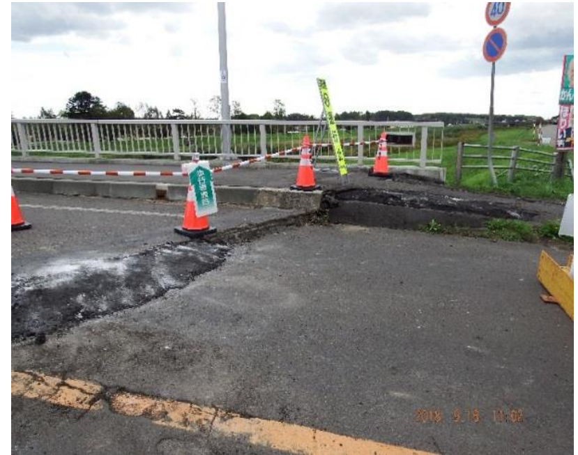
橋台背面盛土の沈下
