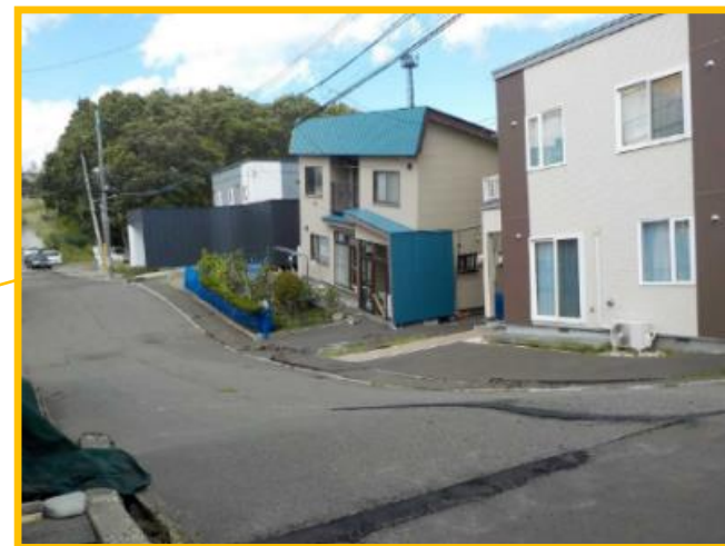
土砂の流出により沈下した道路
