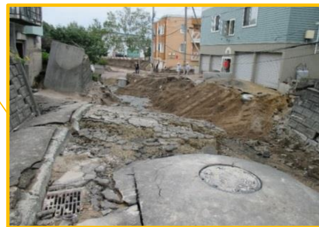
土砂の噴出により 崩壊した道路
