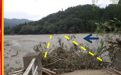
取付部・道路盛土が流失
