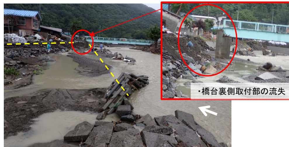
側岸侵食による堤内地盤・道路(黄点線部分)の流失(門地区)
