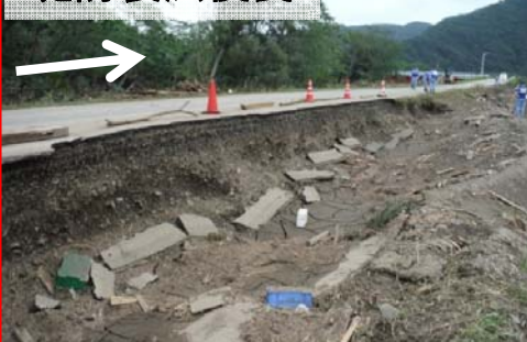
堤防裏法侵食
