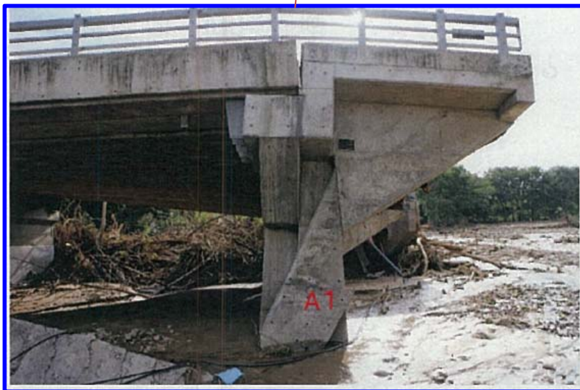
橋台の傾斜沈下(十勝川水系小林川 小林橋)
