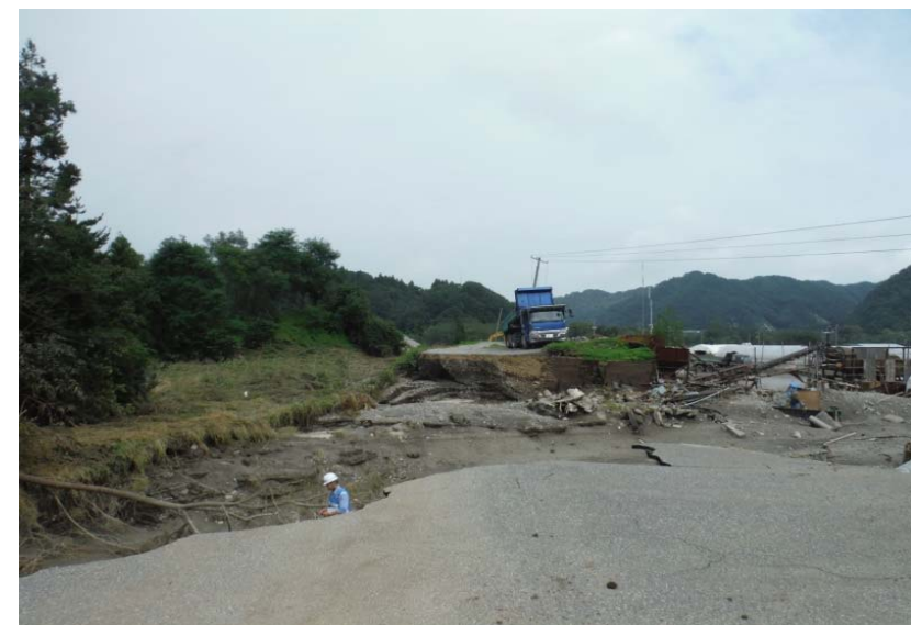
道路崩壊(小本川)
