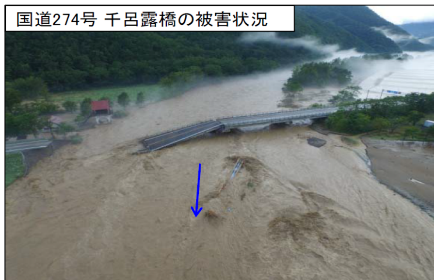
橋梁崩落現場
