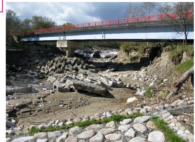
河床低下と橋脚の護床工の変形(ペケレベツ川)
