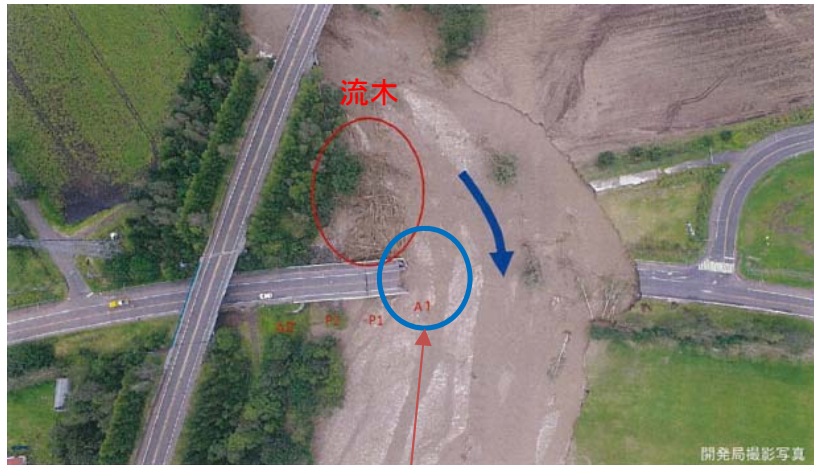
側岸侵食を伴う蛇行による橋脚被害
