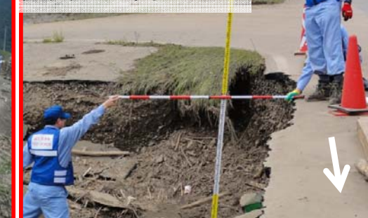
侵食面の高さ:2m
