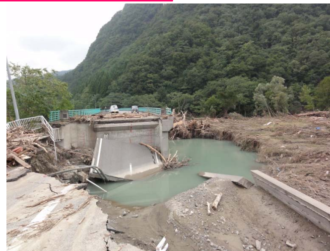
上流側高水敷部の洗掘による取付部路面の落下(乙茂橋)
