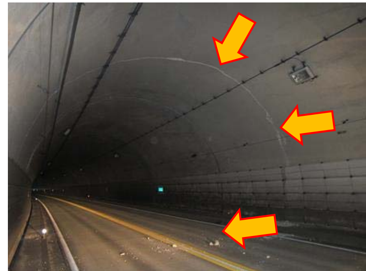
輪切り状のひび割れとわずかなはく落の状況
