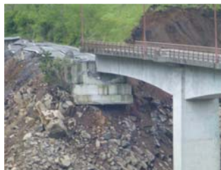
橋台の沈下により 通行止めが発生
