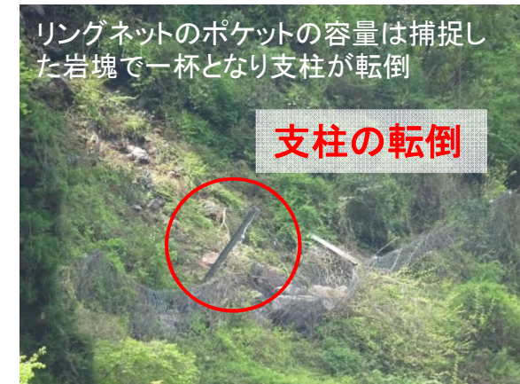
支柱の転倒状況
