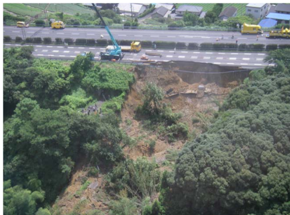
写真-I 盛土崩壊状況
