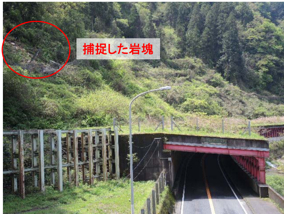
斜面崩壊状況
