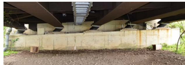
写真-4 ゴム支承の残留変形(扇の坂橋A1橋台)
