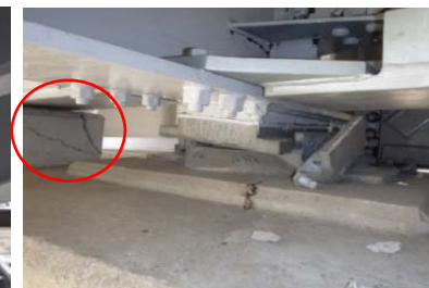
支承の破損の状況
