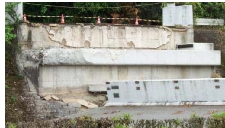
横変位拘束構造の破壊、落橋 (県道小川嘉島線・府領第一橋)
