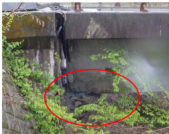
橋梁周辺での大規模な斜面崩壊(上) A2橋台側桁端部の損傷(下) (村道栃の木～立野線・阿蘇長陽大橋)
