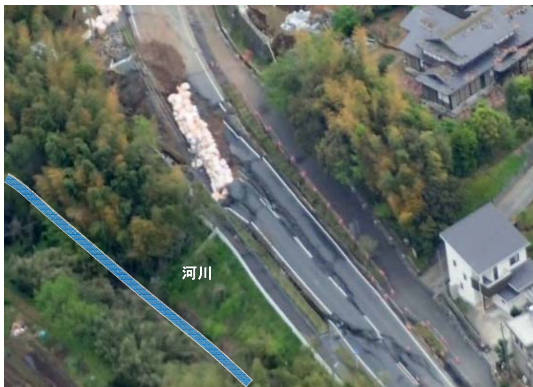
国道443号の盛土崩壊全景
