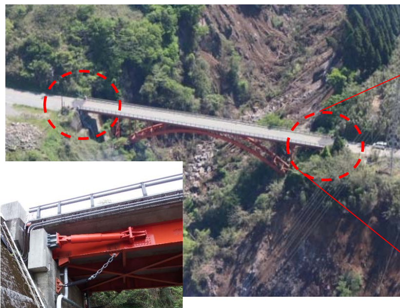
制震ダンパー接合部(変位制限構造への取付)の損傷(国道325号・南阿蘇橋)
