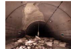
覆工コンクリートの崩落 (俵山トンネル)
