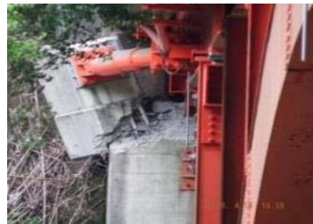
ダンパー取付部の損傷 (国道325号・南阿蘇橋)
