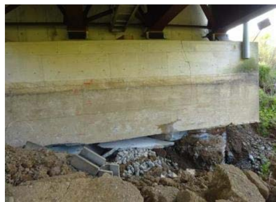
橋台周辺での地盤変状による 橋台の沈下 (県道熊本高森線・俵山大橋)
