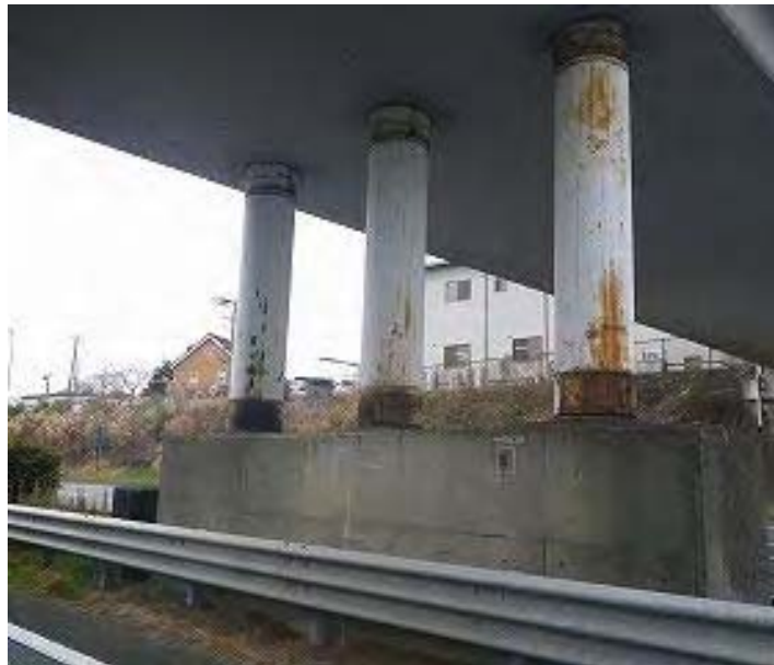
府領第一橋(落橋前)
