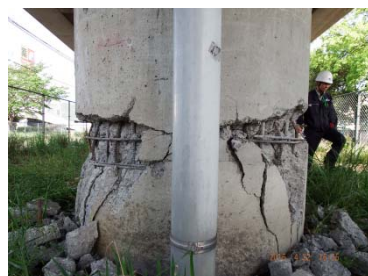
段落し部の損傷 市道(1-3)中央線・中央線陸橋
