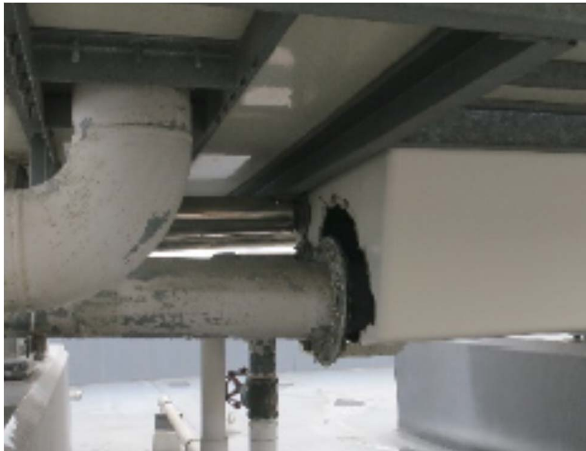
配管接合部の損傷
