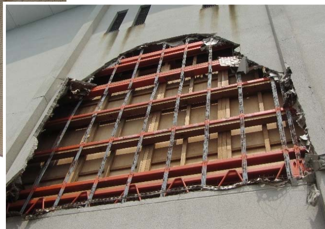
モルタル壁の落下危険
