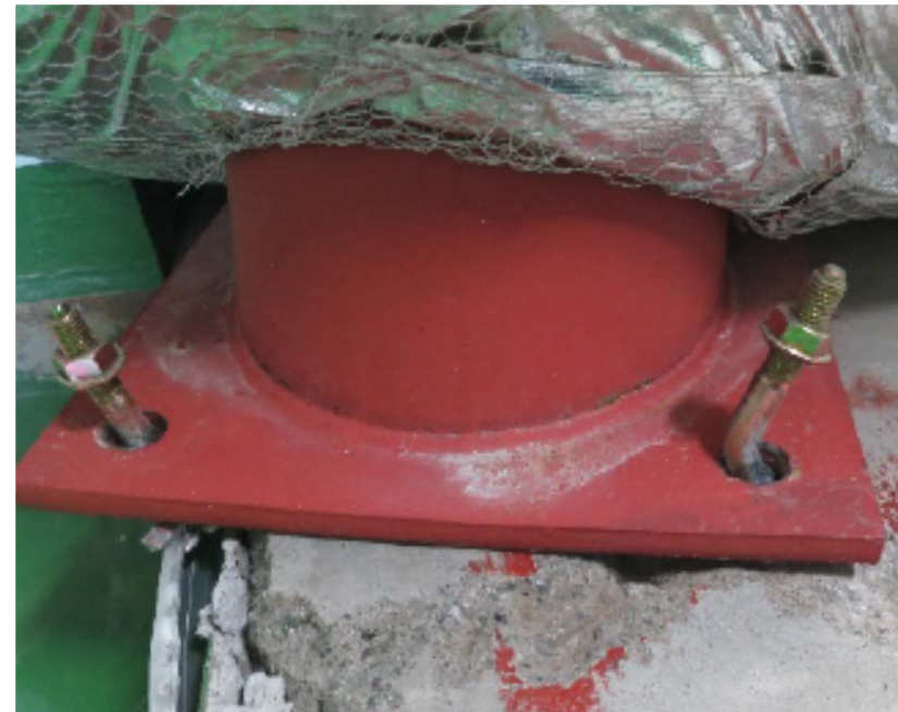
機器据え付け部の損傷
