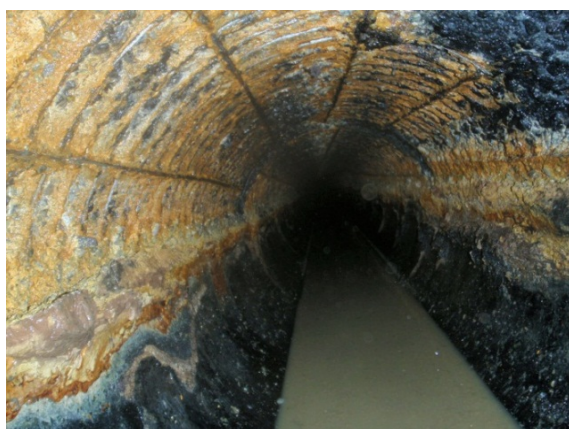
下水管の腐食
