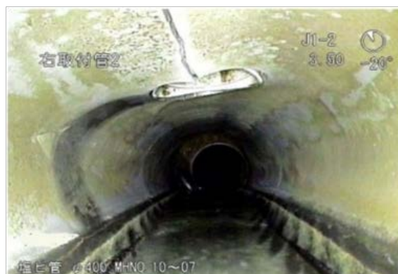
下水管のたわみとクラック
