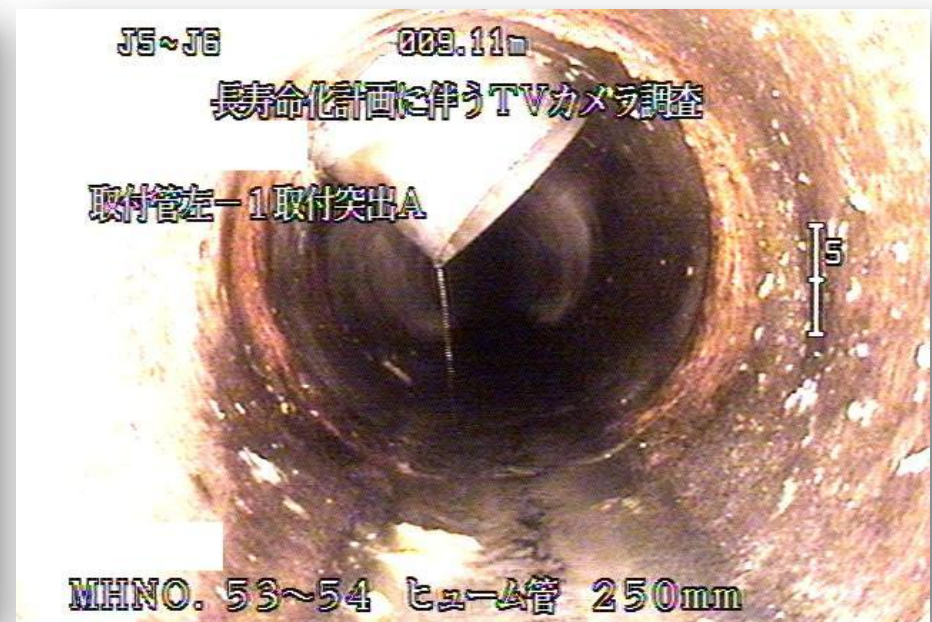
取付管突出しaランク
