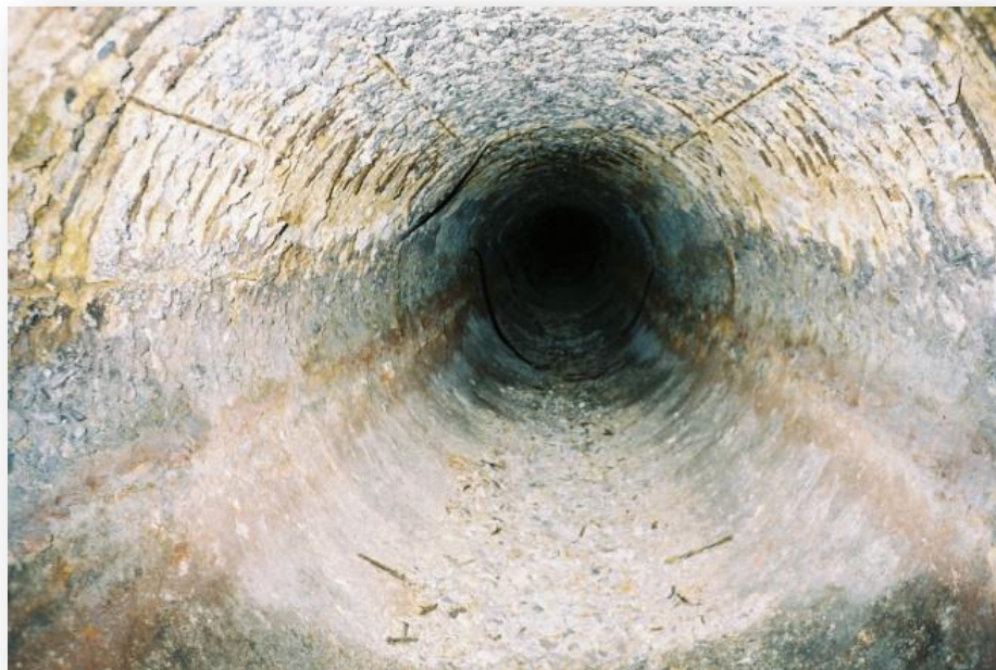
腐食Aランク
