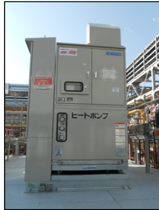
ヒートポンプ
