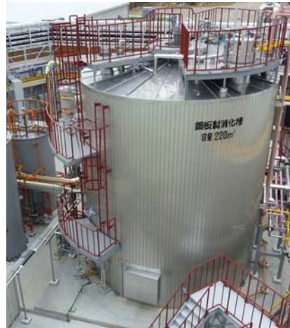
鋼板製消化槽
