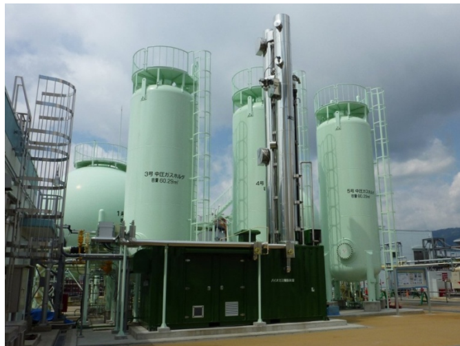
バイオガス精製設備
