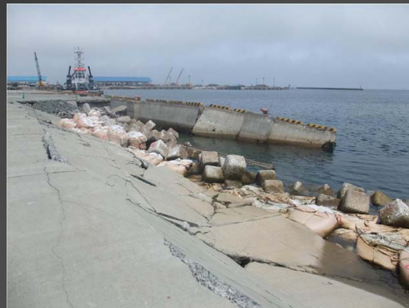
岸壁の倒壊(相馬港)
