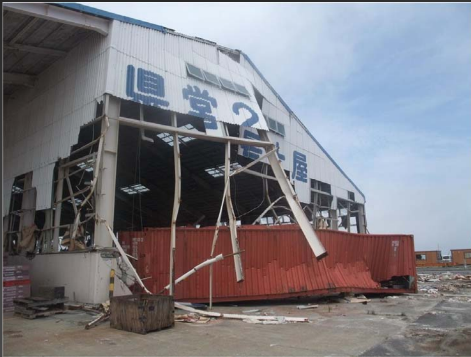
上屋の損傷(相馬港)
