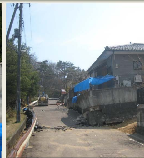
擁壁の被害と住宅の移動
