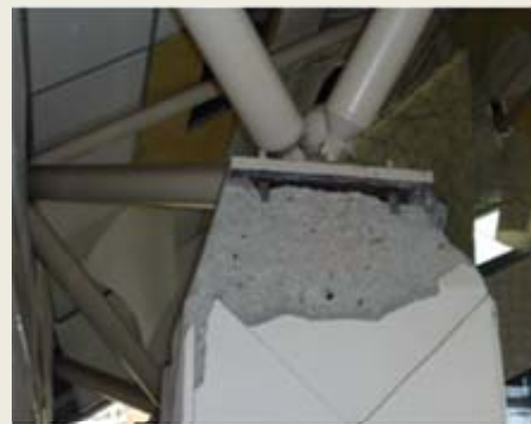
接合部コンクリート剥落
