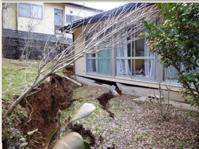
地盤破壊による基礎の破壊
