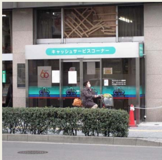
ガラスの破損
