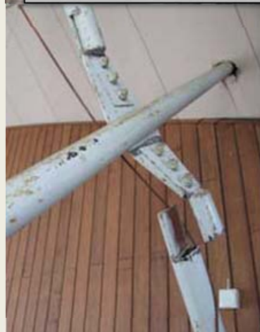
接合部ブレース破断
