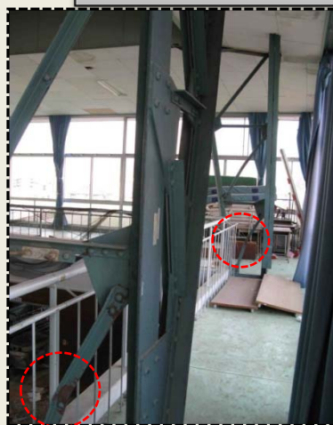
ラチス柱の斜め材の座屈
