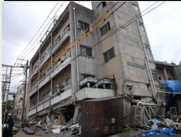
柱のせん断破壊による 弱1層の崩壊
