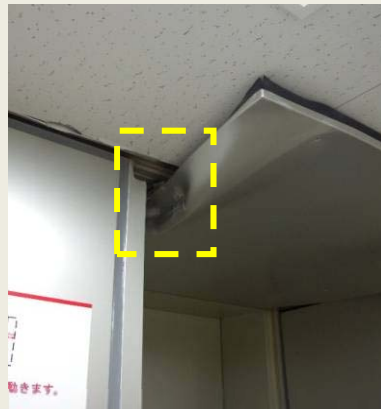
エキスパンション ジョイントの損傷
