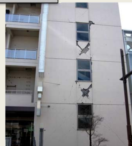
耐震壁開口部の せん断破壊
