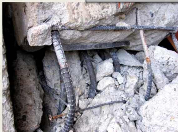
SRC造露出柱脚のアン カーボルトの抜けだし
