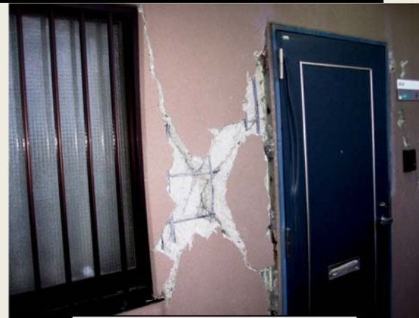
非構造壁のせん断破壊
