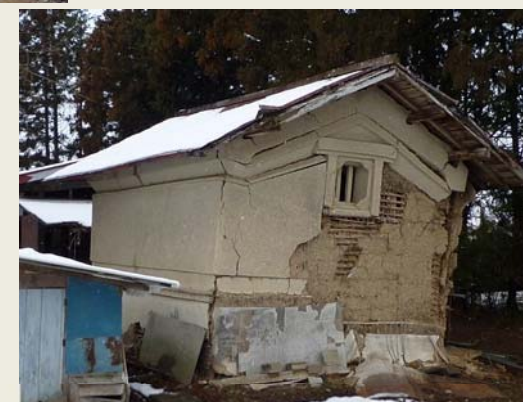
土蔵の被害 (土と漆喰で仕上げた日 本の伝統的木造倉庫)
