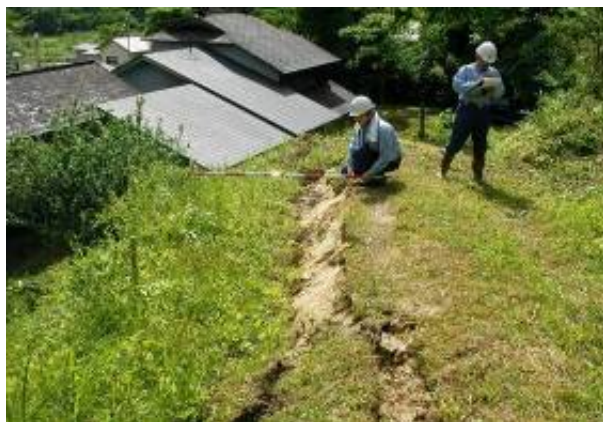
点検で危険度Aと判定された箇所(宮城県旧鳴子町)
