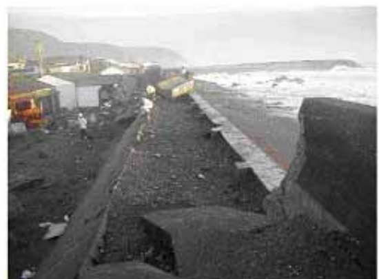
写真-5.3 高知県菜生海岸の被災状況
