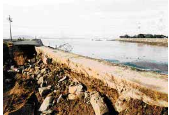
写真-5.2 倉敷市内の施設被災状況
