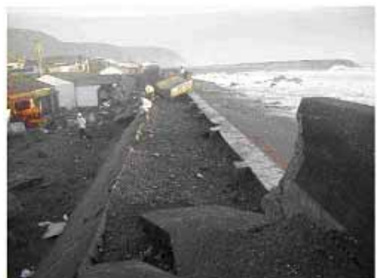
写真-5.3 高知県菜生海岸の被災状況
