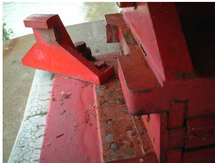
可動支承のサイドブロック の損傷
