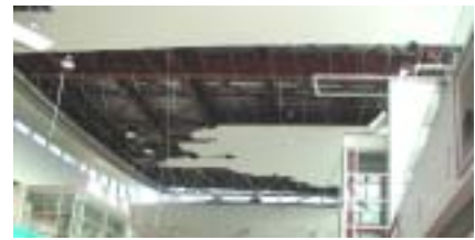
写真-9 落下した天井の様子
