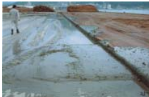
写真-11 大船渡港野々田地区-13m岸壁の被災状況
