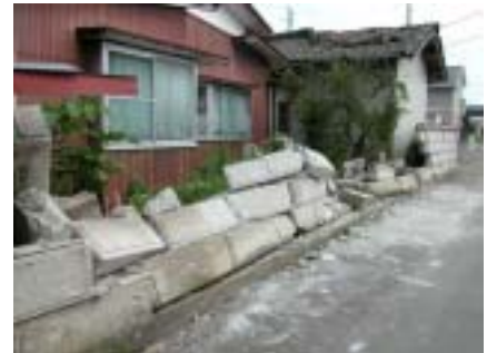
写真-10 岩塀の倒壊例
