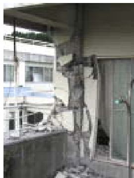
写真-6.4 南東隅柱の被害
