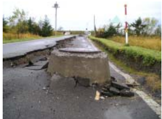
写真-5 マンホールの浮上りと路面の陥没 (豊頃町大津地区)
