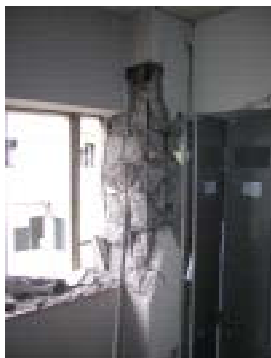
写真-6.3 南面柱の被害
