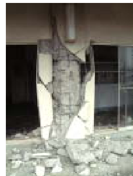
写真-6.5 東面柱の被害
