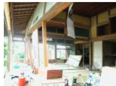
写真-7 木造住宅の被害例
