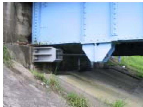
写真2 小野橋の落橋防止構造 (張力が作用した状態で落橋防止が有効に機能したと推定)
