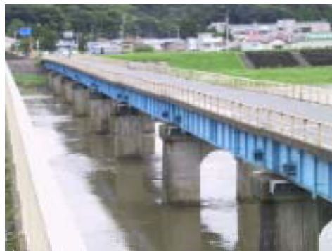
写真1 小野橋 (鳴瀬町、桁の沓逸脱による路面の段差)
