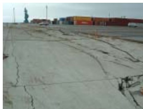
写真-12 釧路港西ふ頭岸壁の被災状況
