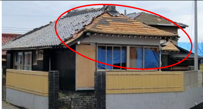
屋根瓦の脱落・飛散(令和元年房総半島台風・館山市)
