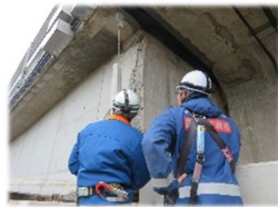
被災橋梁調査（能登半島地震）
