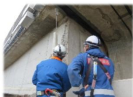
被災橋梁調査（能登半島地震）
