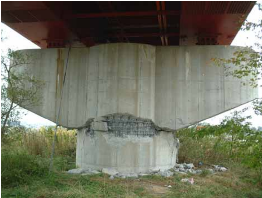
かぶりコンクリートの剥離、 軸方向鉄筋のはらみ出し
