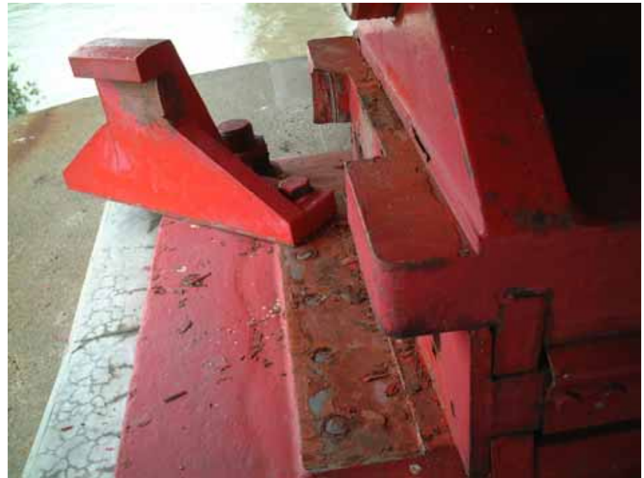
可動支承のサイドブロック の損傷
