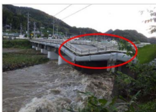
写真 3.5 橋脚の沈下事例 (法雲寺橋・2019 年台風 19 号) 出典：関東地方整備局 記者発表資料
