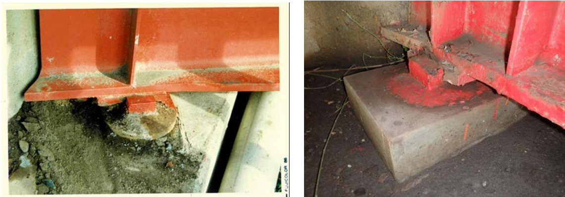
写真 3.2 古川橋支承写真（左：昭和 63 年撮影 A2-G1 右：平成 31 年撮影 A2-G3）
