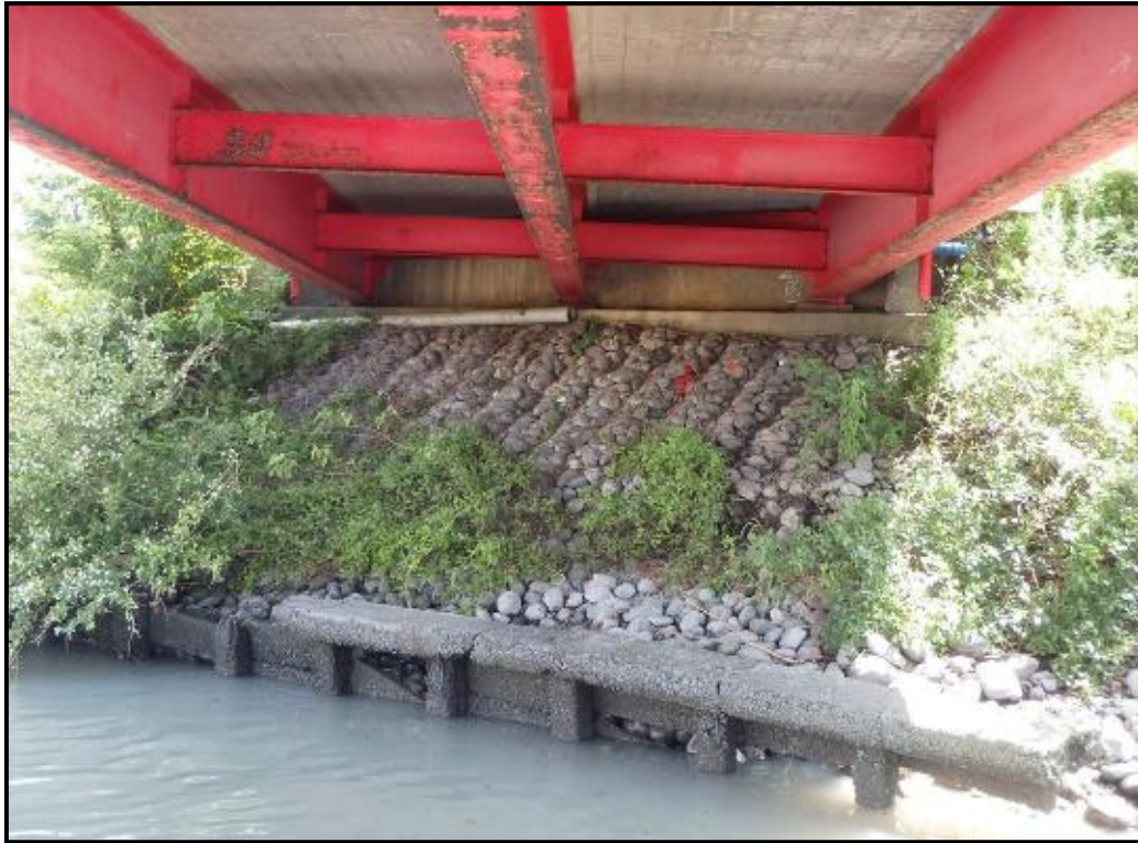
写真 4.3 代表的損傷状況 護岸：変形・欠損（A2 橋台）
