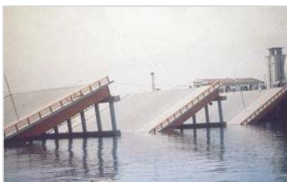
写真 3.4 パイルベント橋脚・基礎の落橋事例 (昭和大橋・1964 年 新潟地震) 出典：土木研究所(CAESAR)技術資料
