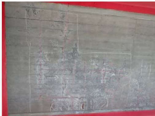
ひびわれ発生状況
