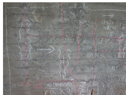
ひびわれ部拡大写真 d
