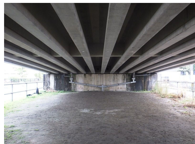
③A1橋台:漏水
