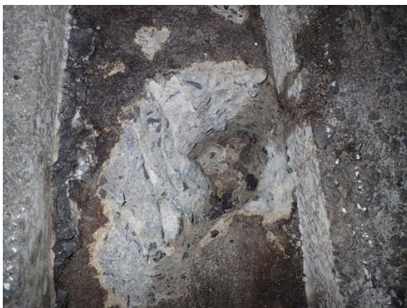
※調整コンのひびわれは床版上面には及んでいない
