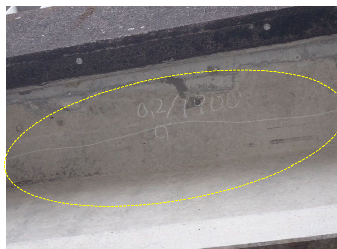
⑧主桁(P2-P3上流側):ひびわれ
