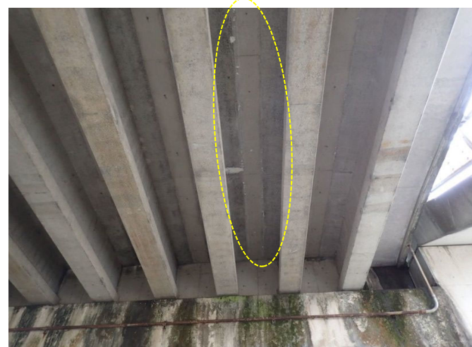
⑦間詰部(P3-P4上流側):遊離石灰
