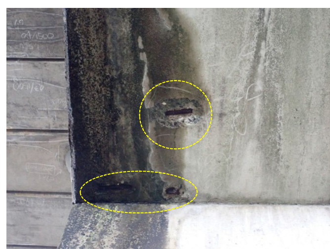
⑨P6橋脚梁部 (下流側): 鉄筋露出
