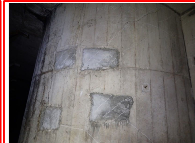
⑩P9橋脚柱頭部(上流側より): ひびわれ
