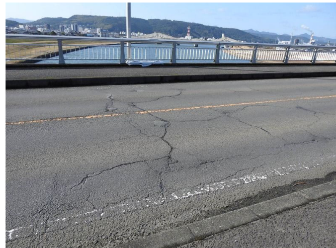
①橋面 (P8-P9)上流側より: 舗装ひびわれ
