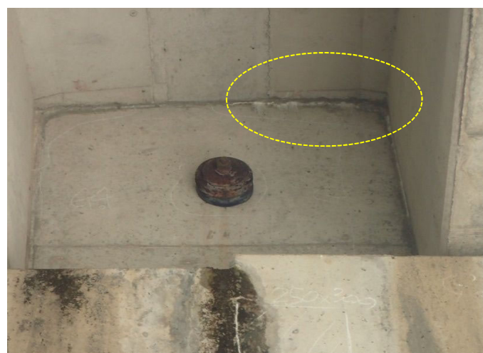
⑧横桁(P13): 遊離石灰(主桁境界部)
