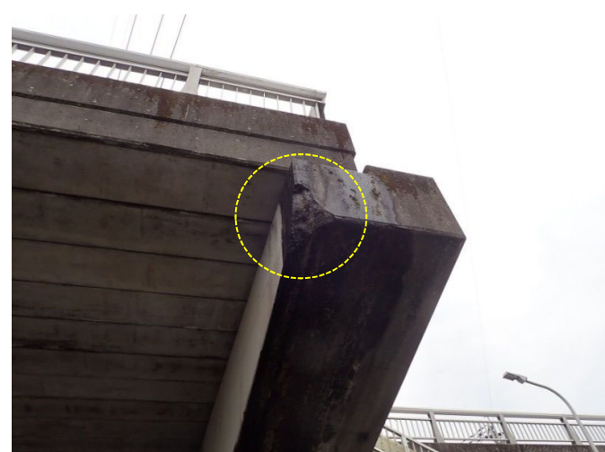
⑧P6橋脚梁部 (上流側): 欠損
