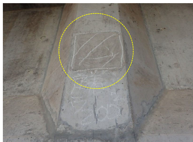
⑨PC定着部(P15-A2,中間横桁G7): 跡埋め部のうき
