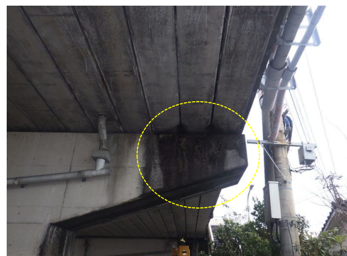
④P7橋脚 (下流側P8側): 地覆、歩道部からの漏水
