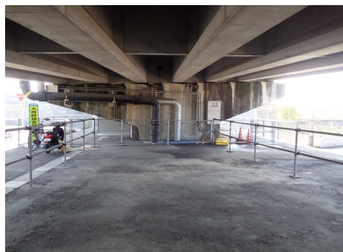
⑤P15(終点側): 伸縮装置からの漏水
