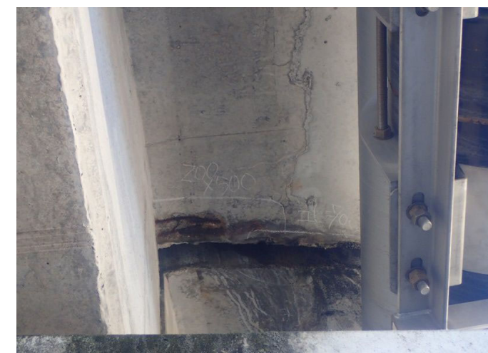
⑦張出床版(P15上流側): 漏水、鉄筋露出
