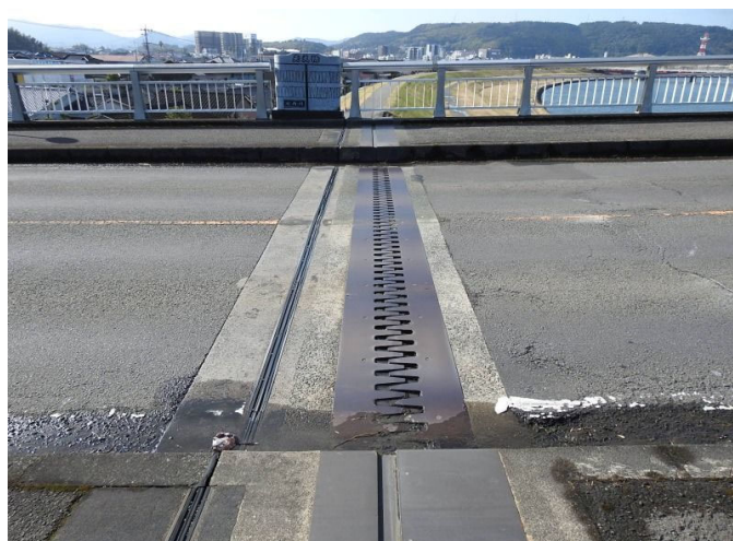
③伸縮装置 (P8)上流側より: 土砂詰まり(路肩部)
