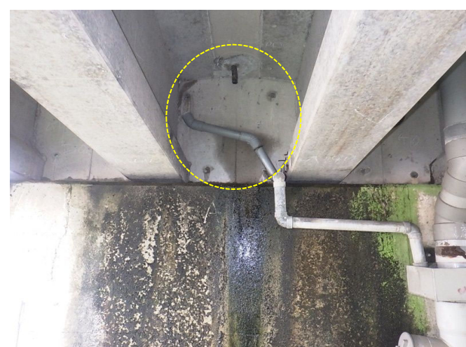
④排水装置(A1上流側):変形・欠損
