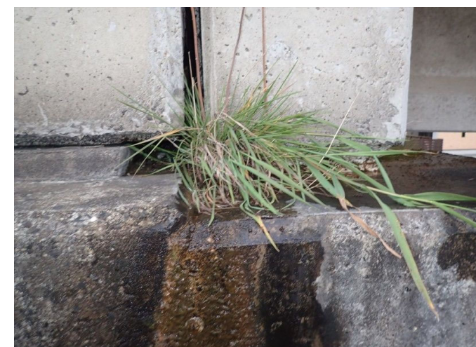
⑤梁部(P2下流側):段差:植生
