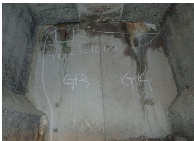
⑥横桁(P2-P3端横桁P2側):遊離石灰、鉄筋露出
