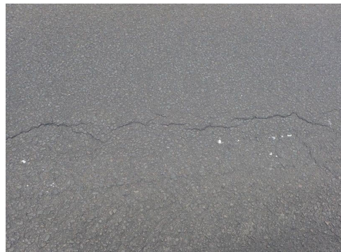
②橋面(P14-P15): 舗装ひびわれ
