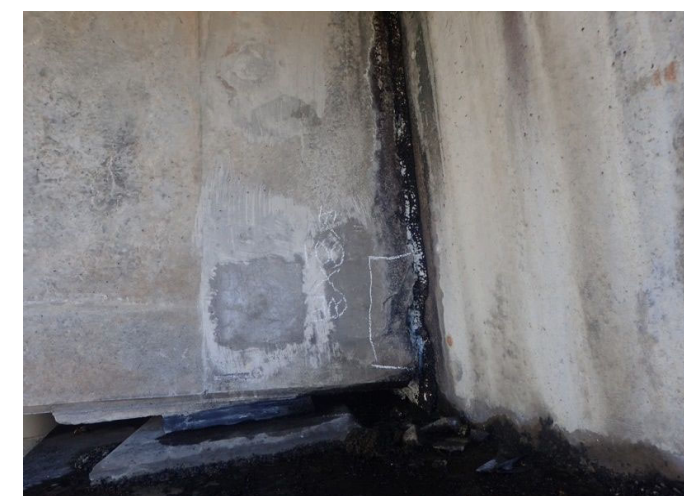
⑪主桁端部、支承(A2上流側): 剥離、漏水
