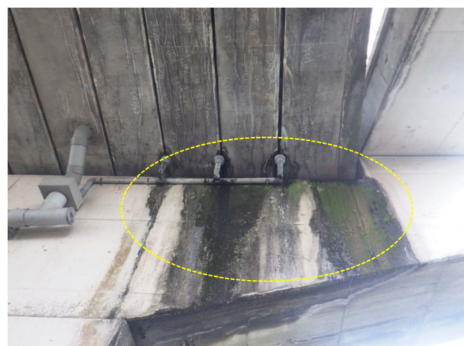
⑤排水装置 (P6下流側P7側): 排水不良
