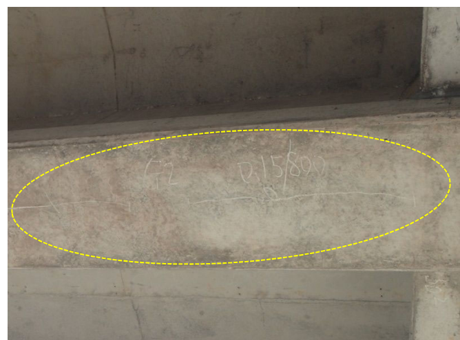
⑥主桁(P14-P15,G2): 橋軸方向のひびわれ
