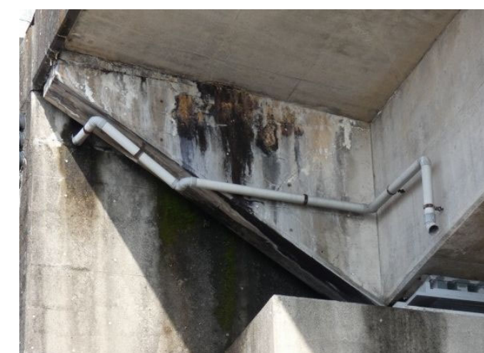
⑥横桁 (P11)下流側: 漏水・遊離石灰
