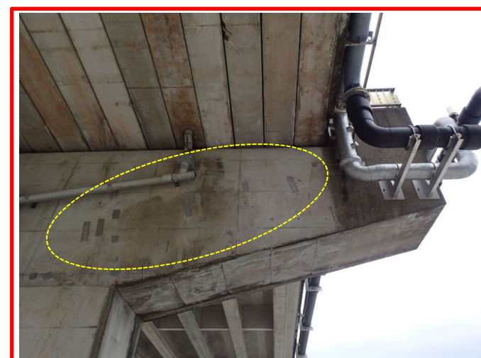
⑩P12橋脚: 補修跡の再劣化
