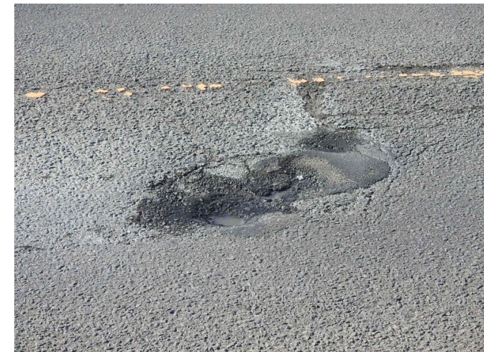
②橋面 (P8-P9)上り線: ポットホール
