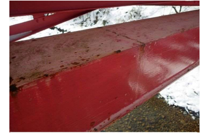
写真-5.1.4 局所的腐食状況 (写真番号 4)
