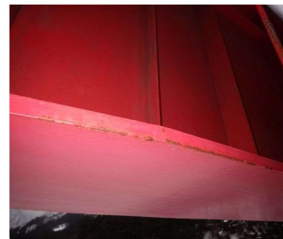
写真-5.1.11 下フランジ角部 (写真番号 11)
