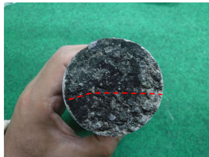
写真-5.3.10 P1 橋脚の天端から採取したコア (コア外面)
