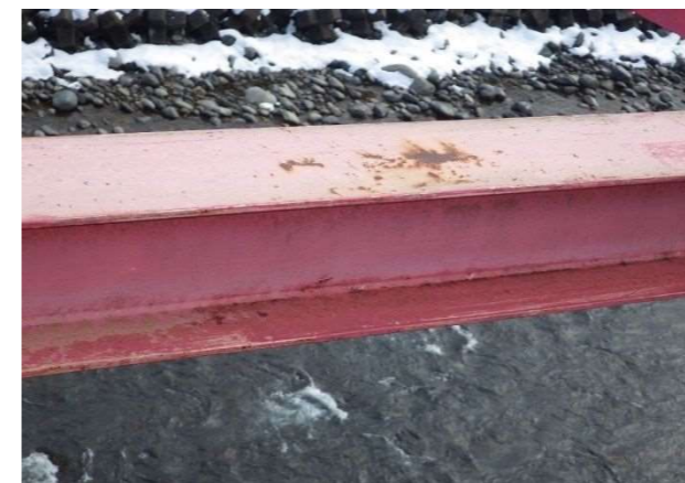
写真-5.1.3 局所的腐食状況 (写真番号 3)
