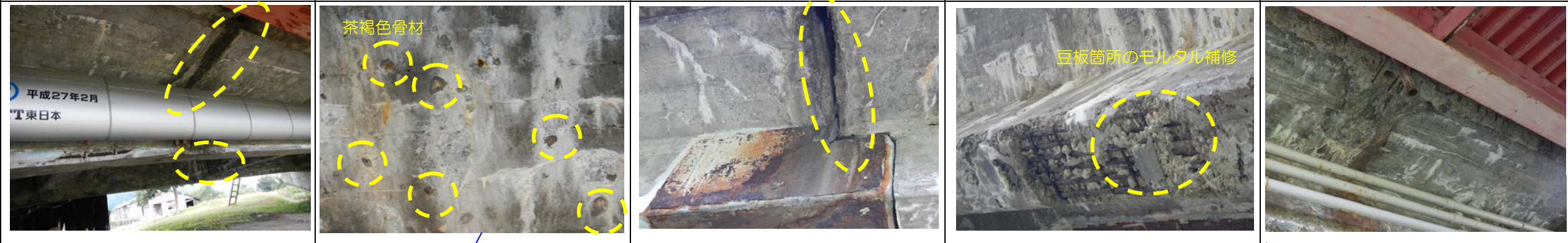
主桁：漏水/剥離・鉄筋露出（第2径間） 張出し床版：茶褐色骨材(第2径間) 張出し床版：剥離・鉄筋露出(第3径間) 主桁：豆板、剥離・鉄筋露出(第4径間) 張出し床版：剥離・鉄筋露出(第4径間)
