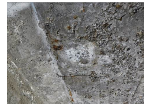
床版漏水箇所
