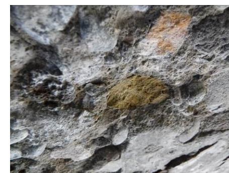
床版骨材の破断状況
