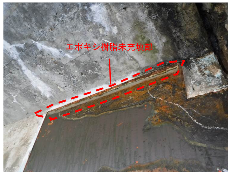
エポキシ樹脂未充填状況
