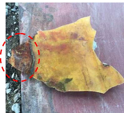
エポキシ樹脂と鋼板の腐食
