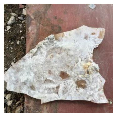
エポキシ樹脂に付着して 剥離したコンクリート
