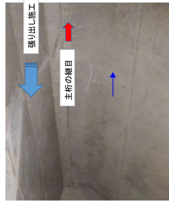
打継ぎ目から発生したひび割れ
