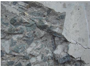
写真-4 ひびわれ①(一部)
