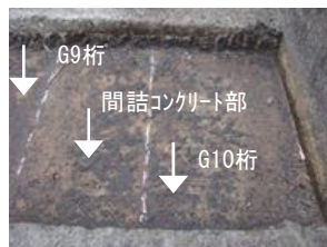
写真-5 損傷部桁上面
