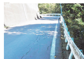
写真-5 舗装亀裂
