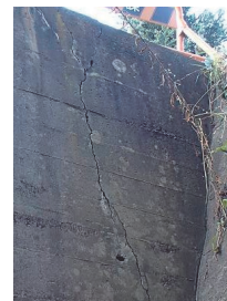
写真-4 橋台ひび割れ
