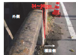
写真-6 高欄の傾斜
