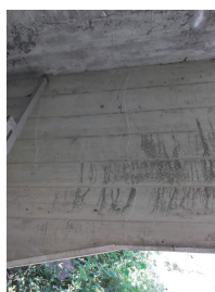
写真-7 主桁のひび割れ
