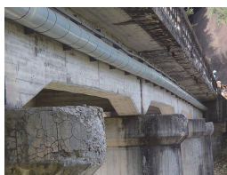
写真-2 ひび割れ状況
