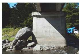
写真-3 巨岩の衝突
