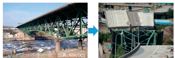
写真-4 米国I-35W橋（ガセットの破壊から崩落）
