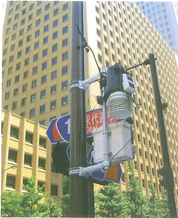
街路灯に設置した気象観測装置
