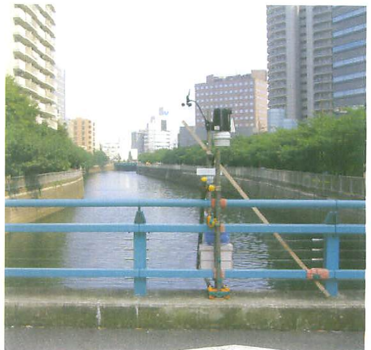
橋上に設置した気象観測装置
