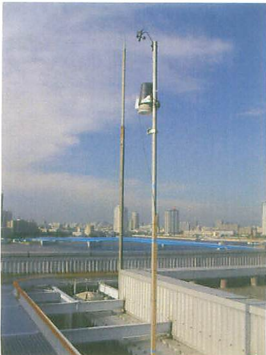
屋上に設置した気象観測装置
