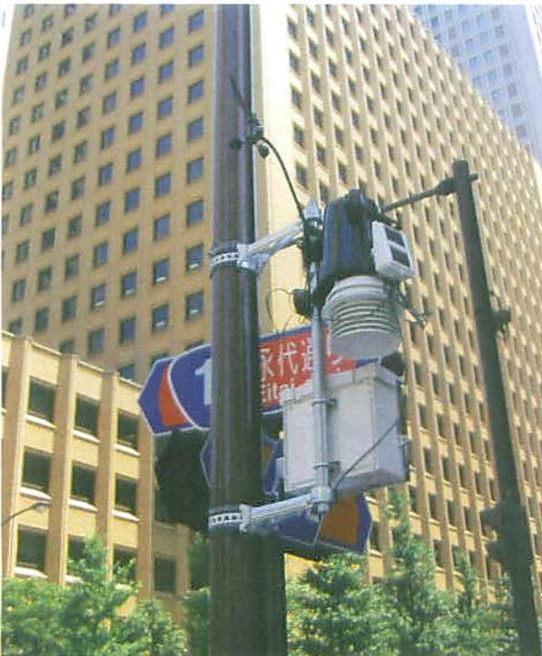
街路灯に設置した装置
