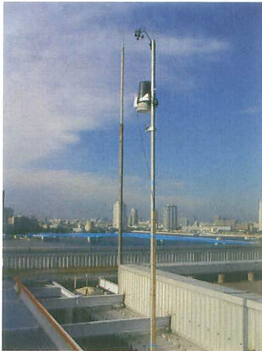
ビル屋上に設置した装置
