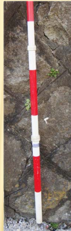
擁壁前面の積み石に沿って、縦・斜めクラックがある。
