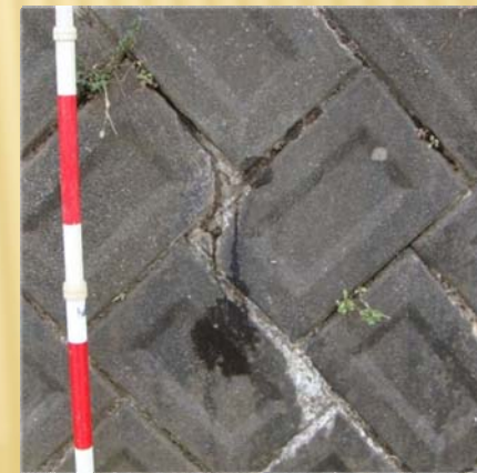
クラックから白色生成物が析出し、漏水もみられる。
