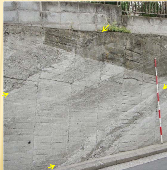
コールドジョイントの認められるコンクリート擁壁。
