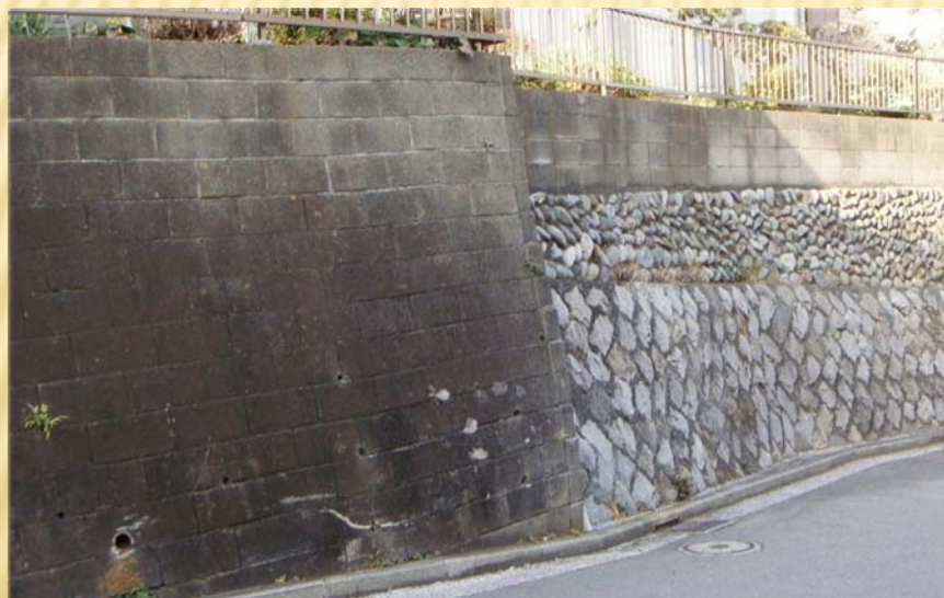
写真左側の間知ブロック積み擁壁は明らかに後傾しており、 写真右側の練石積み擁壁は、やや後傾している事例。
