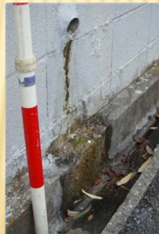
水抜き穴からの流出
