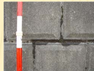
擁壁表面が湿っている
