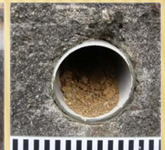
細粒土砂で詰まった水抜き穴
