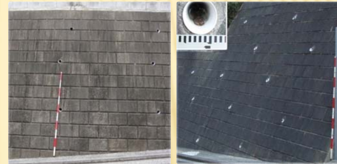
3m 2 に1ヶ所、内径75mm以上の水抜き穴が設置されている擁壁
