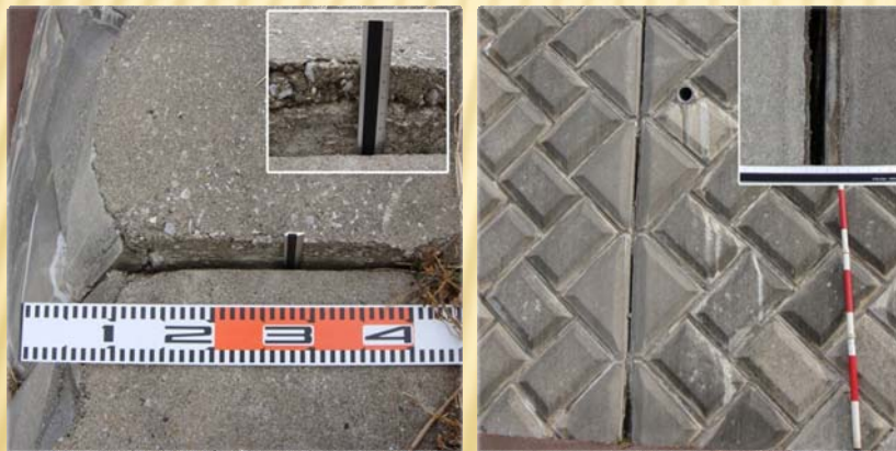
上下の段差を伴うコンクリート擁壁の開き
