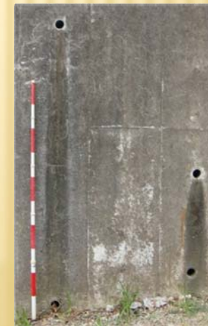
最近水が流出した痕跡
