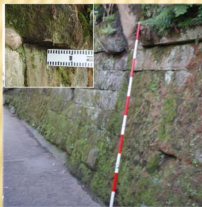
積石の凹凸やせり出し、擁壁の膨らみが認められる。
