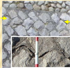
積石の目地部分に沿った横クラック。
