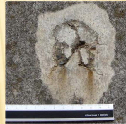
コンクリート擁壁に発生した白華現象
