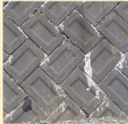
積石の数箇所から白色生成物が析出してあり、その高さが一定である。
