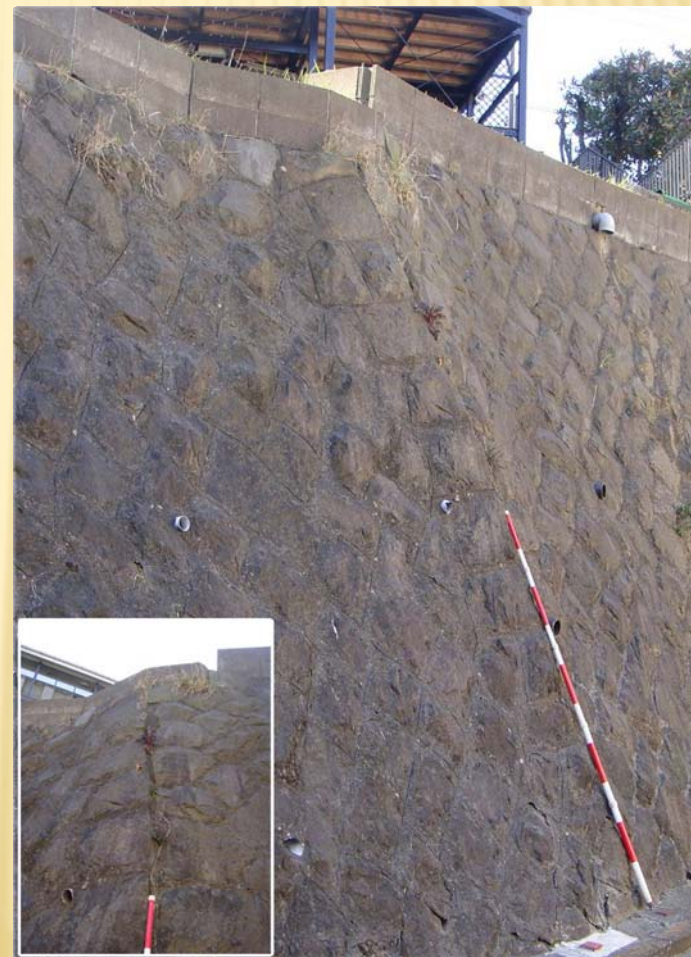
目地の部分がふくらんでいる練石積み擁壁。
