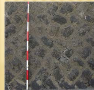
水抜き穴が設置されていない
