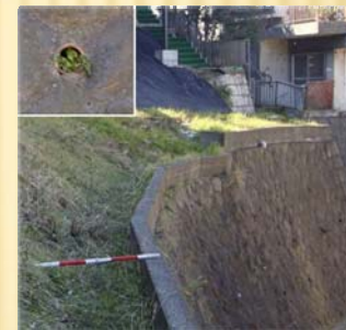
水の浸透しやすい擁壁 天端と詰まった水抜き穴
