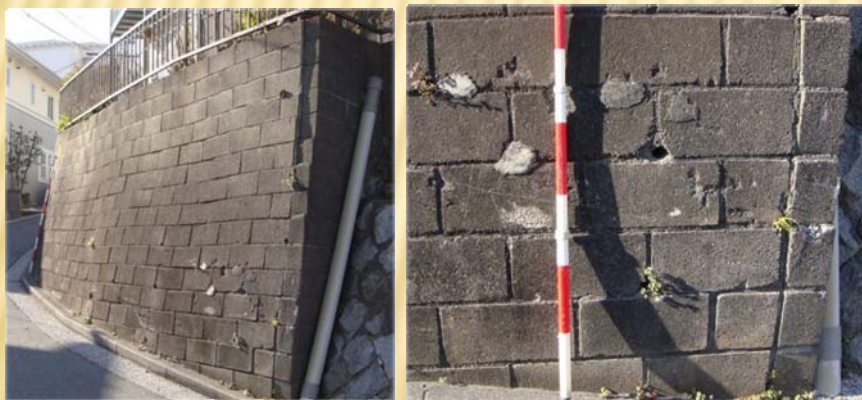
擁壁表面がふくらんでおり、積石が浮きだしている部分が認められる。
