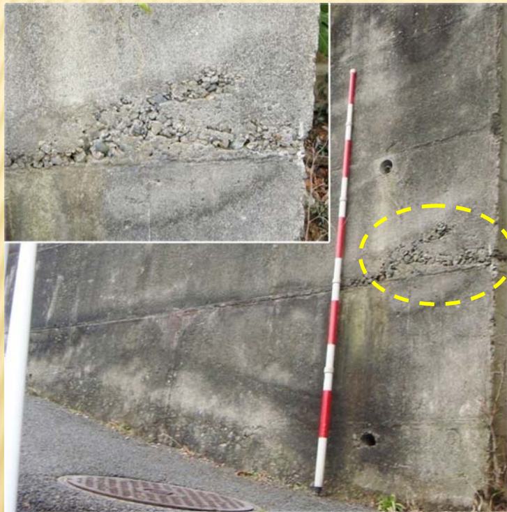
ジャンカの認められるコンクリート擁壁。
