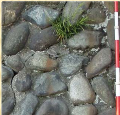
石の表面が風化している空石積み擁壁。
