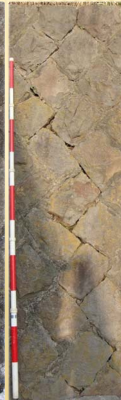
積み石に沿った縦・斜めクラックの幅が大きく隙間ができています。
