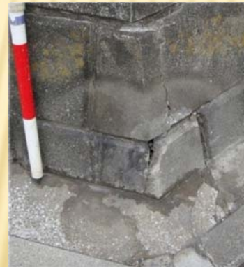
コーナー部の斜め方向にクラックがあり、水のしみ出し跡がある。
