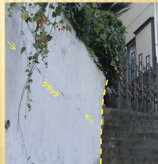
明らかに前傾しているコンクリート擁壁。
