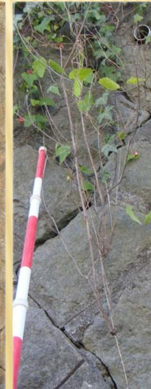
擁壁が縦・斜めクラックを境に上下にずれている。
