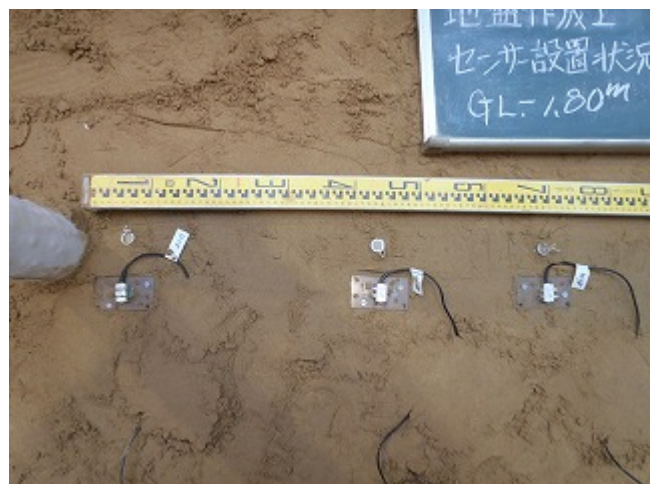
写真 3.8.6 センサー設置状況
