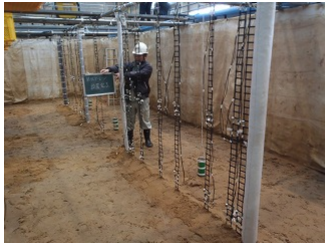
写真 2.3.4 センサー固定状況 2
