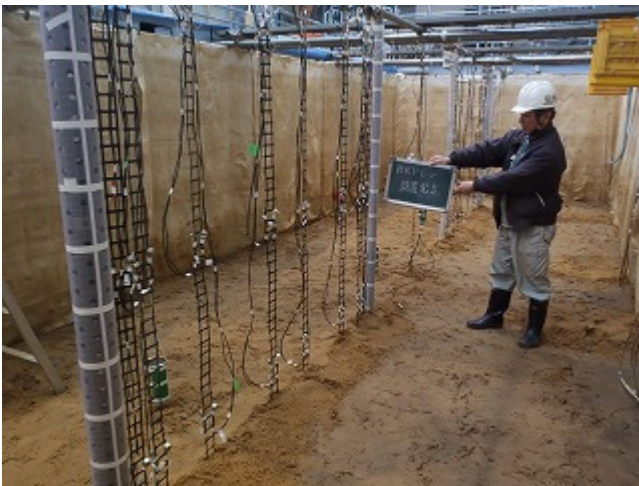
写真 2.3.3 センサー設置状況 1
