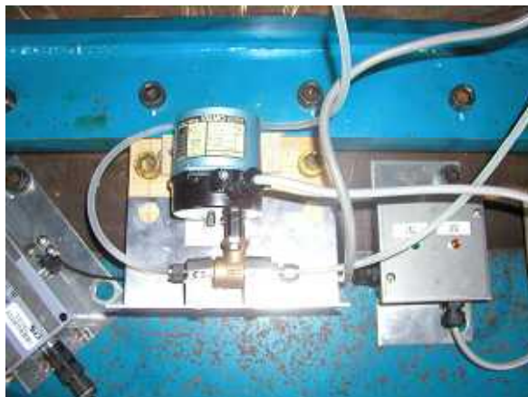
写真 2.2-8 電動式の排水弁
