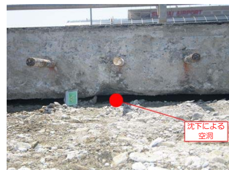
仙台空港のエプロン(コンクリート舗装)の液状化による局所沈下
