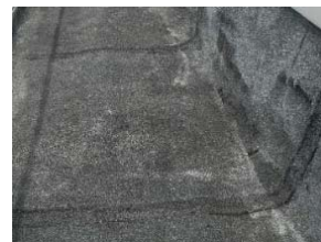
防水層の膨らみ。長寿命化には防水層の撤去が必要
