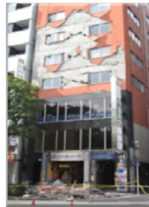
タイル外装材の落下
